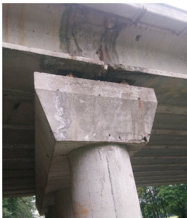
Obrázek 21 - Vápenné výluhy na stativu P2P a odpadající beton
