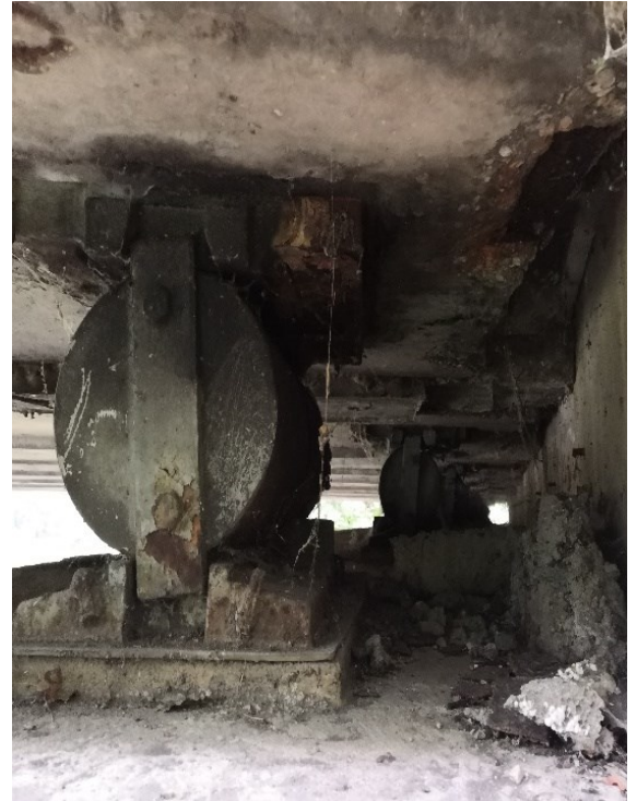
Obrázek 15 – Odpadlý beton na úložném prahu z ochranných obetonávek závěrné zidky OIL
