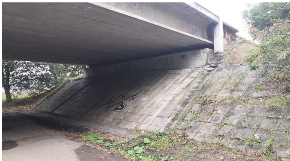
Obrázek 22 - Svahový kužel u O4P, nefunkční odvodňovací žlábek a opevněním prorůstající vegetace
