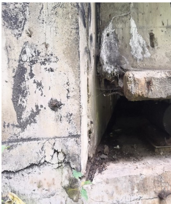
Obrázek 18 - Trhlina v závěrné zídce u O1P
