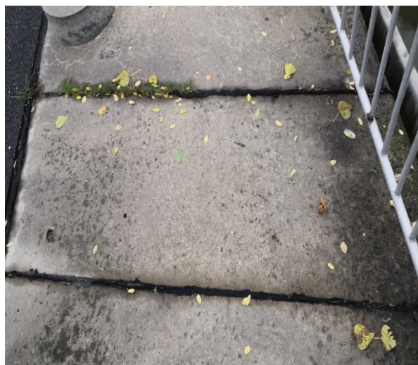
Obrázek 27 – Vyrůstající vegetace z asfaltové zálivky
