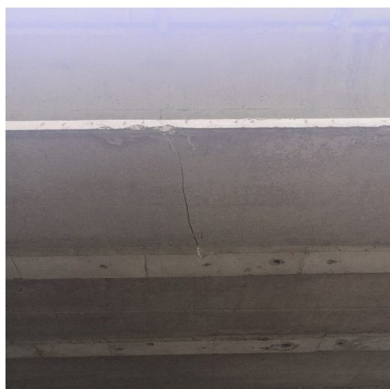
Obrázek 24 – Masivní trhlina v prefabrikátu, lokálně odpadlý beton a odhalení výztuže
