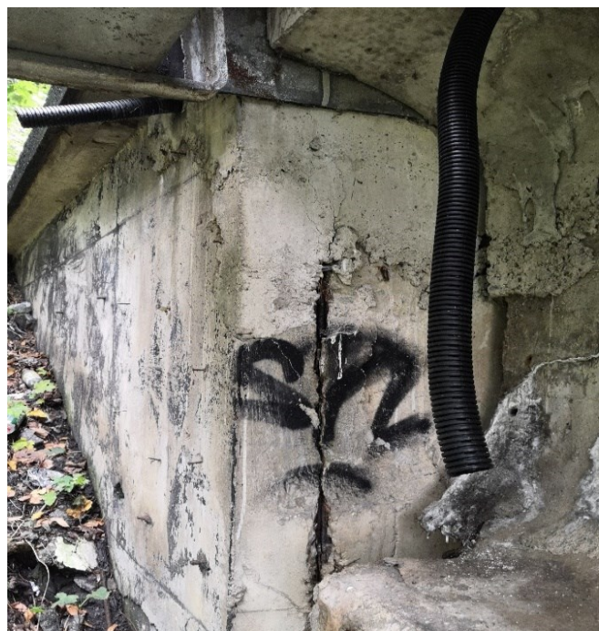
Obrázek 19 - Nedostatečné krytí výztuže u O1P
