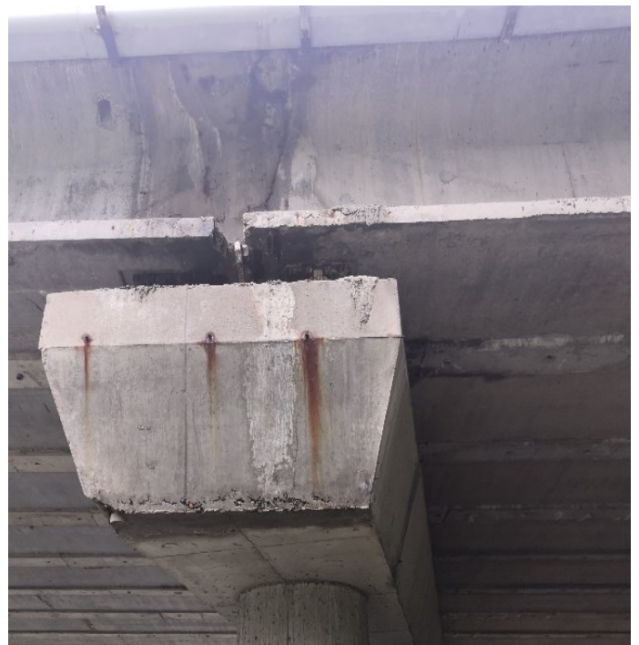
Obrázek 17 – Svislé výluhy a korodující výztuž bez krycí vrstvy u P2L
