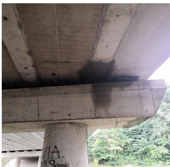
Obrázek 23 - Nefunkční izolace mostu, masivní průsaky
