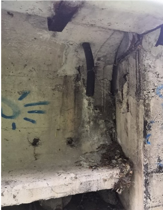
Obrázek 14 - Ukončení nosníku u OIL, patrné svislé výluhy a trhliny v nosníku, vysprávka závěrné zidky
