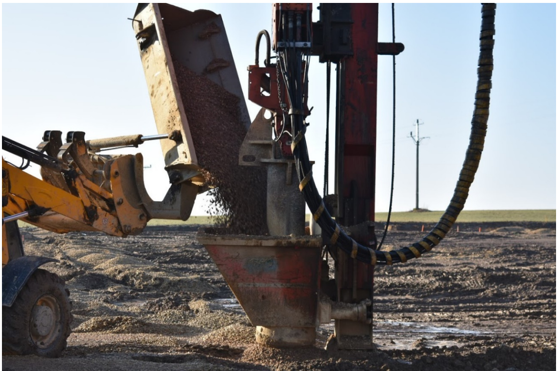
Obrázek 12. Detail násypového koše
