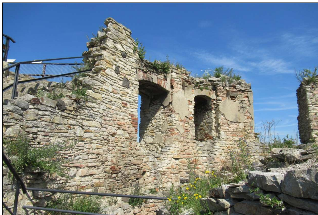
Foto 34. Pohled z prostoru „malé světničky“ na severní úsek „vnější obvodové zdi“ s meziokenními pilíři. Současný stav. Foto autor, 15. 7. 2020.
