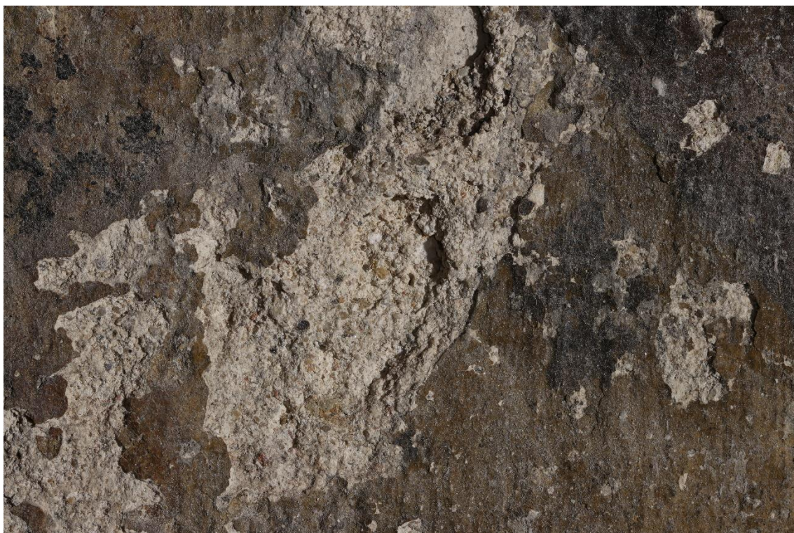
Obrázek 15: Poškození barevné i omítkové vrstvy vlivem vlhkosti působící pod fixací uzavřeným povrchem barevné vrstvy.
