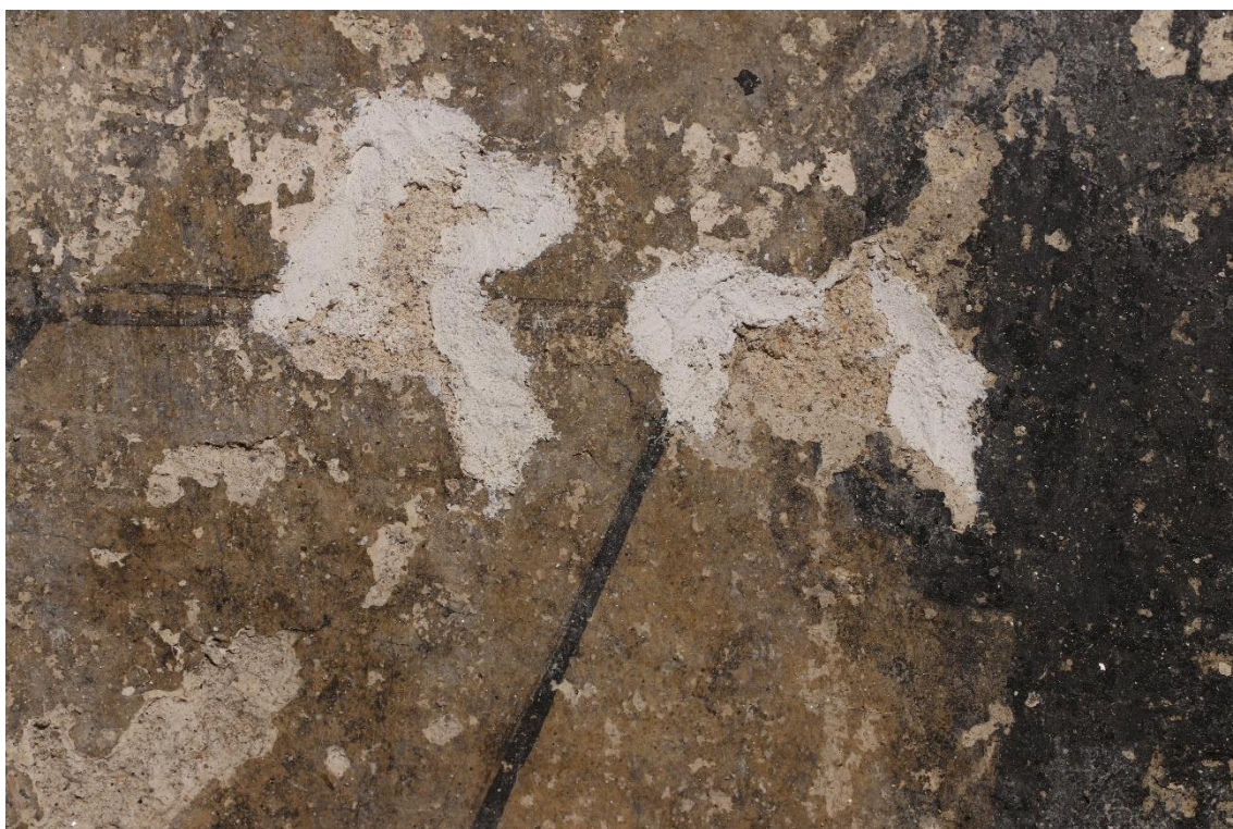
Obrázek 6: Pohled na zajišťovací tmely z předchozího restaurování.
