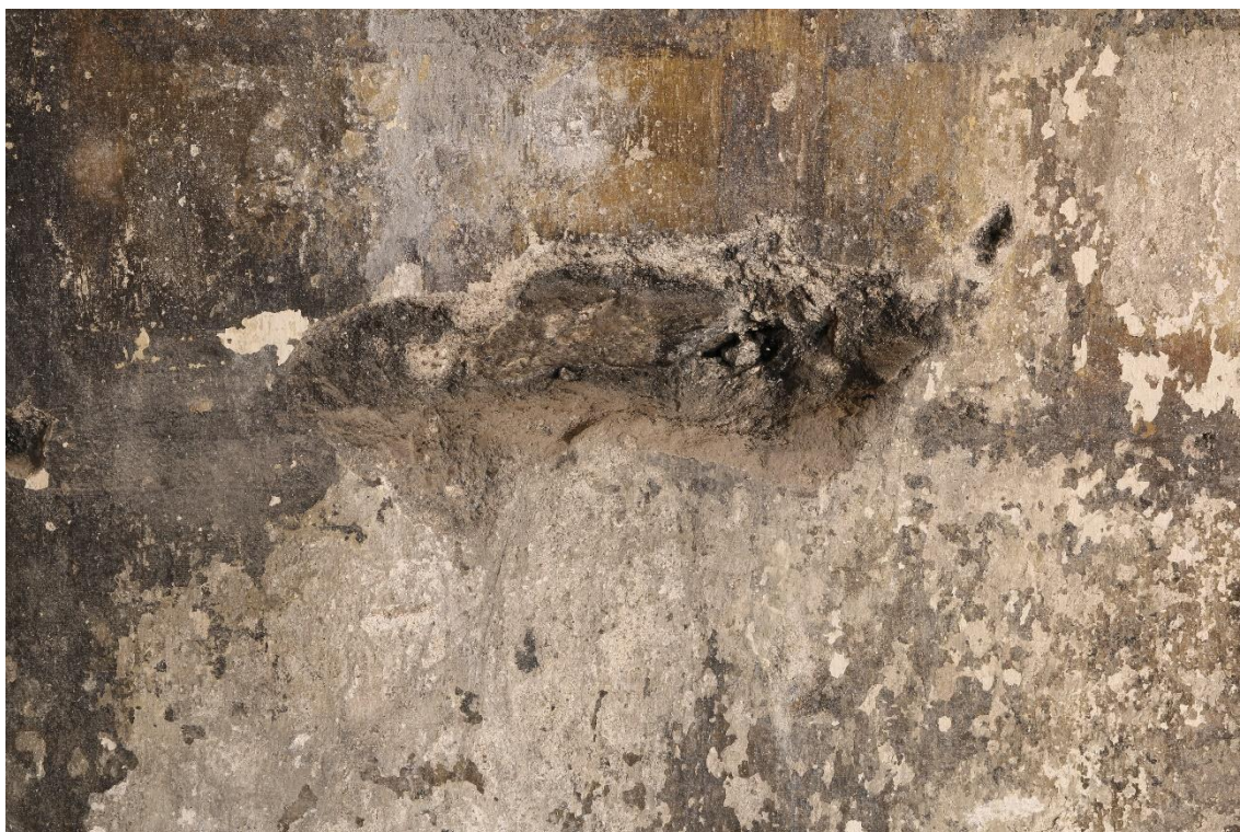
Obrázek 17: Mechanické poškození omítky v oblasti řečnického pultu.
