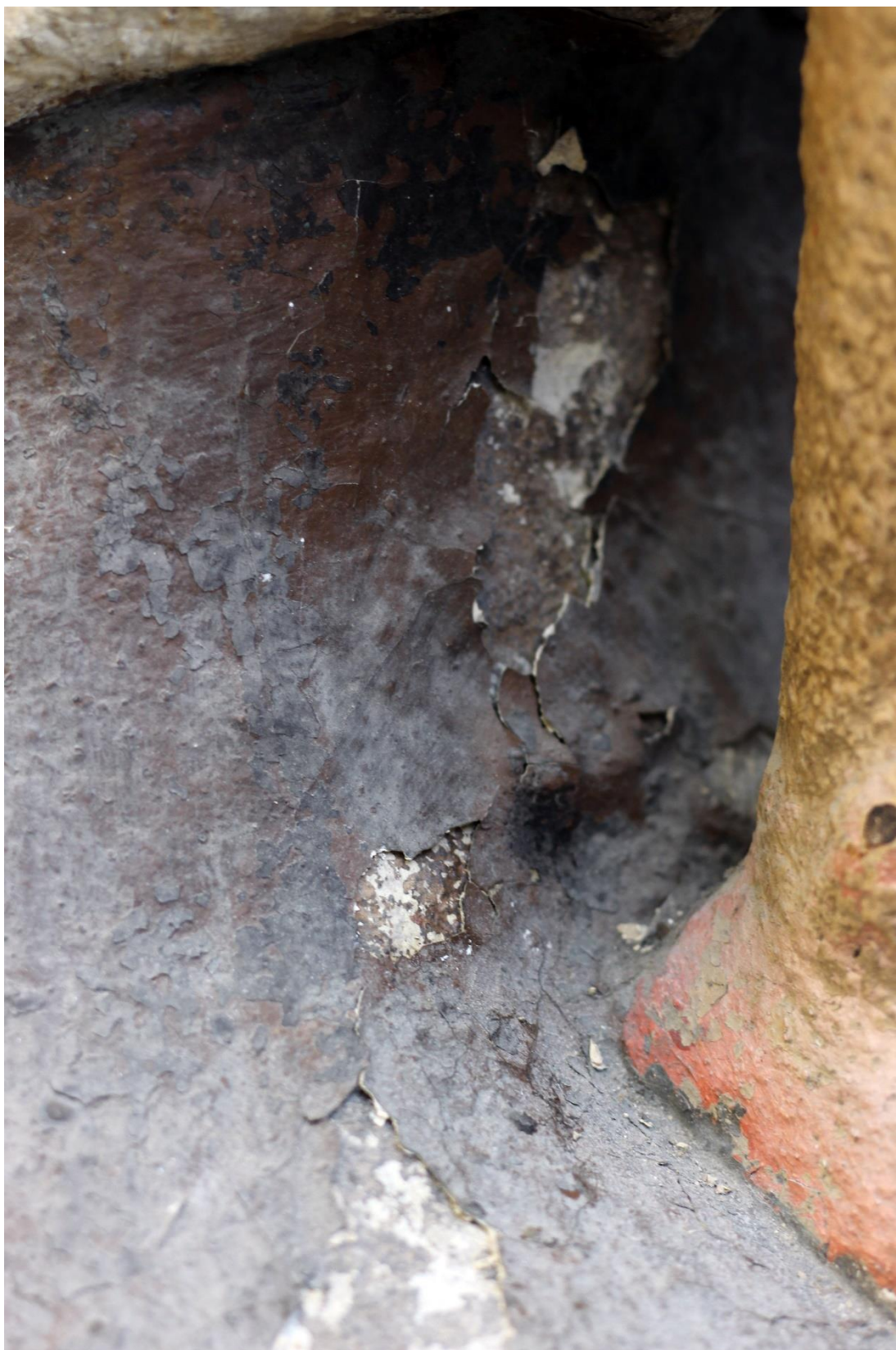
Obrázek 27 Stav před restaurováním – detail poškození – puchýřkovatění a odlupující se barevná vrstva
