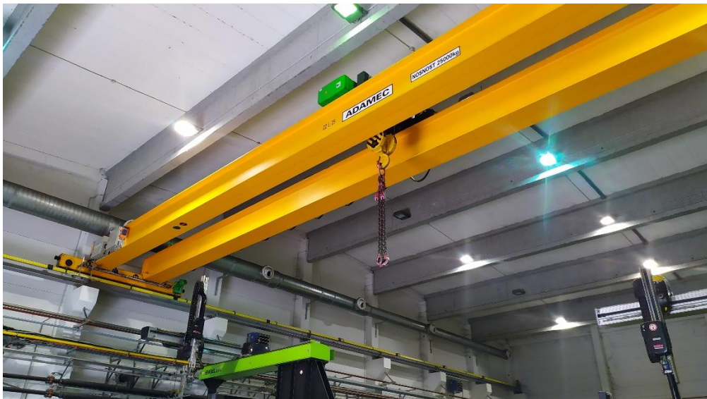
Obrázek 22: Mostový kolejnicový jeřáb s nosností 25 tun
