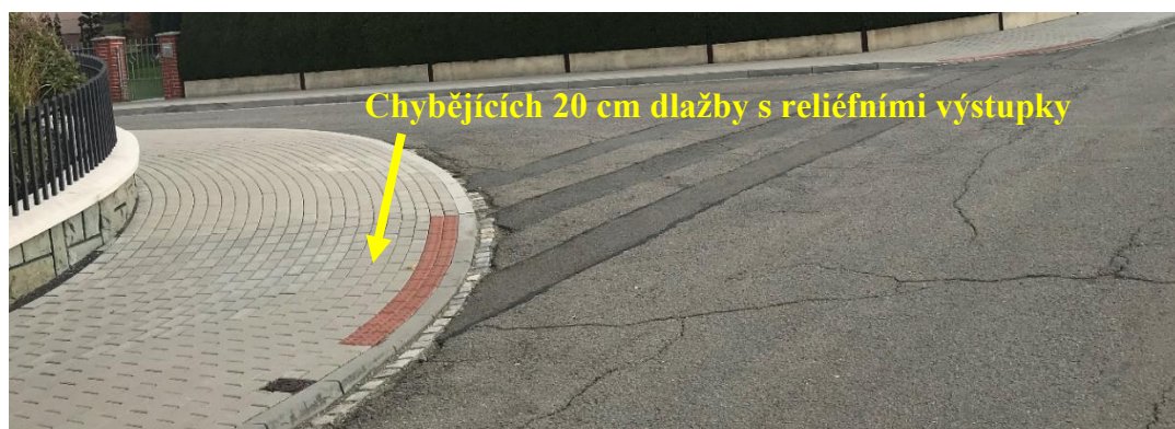
Obrázek 13 Chybné bezbariérové prvky v ulici Moravská
