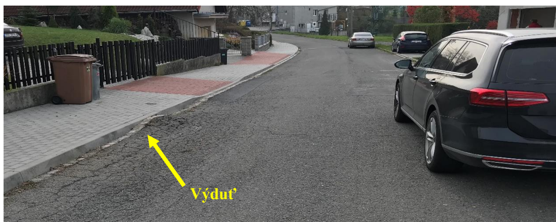
Obrázek 9 Výdut' v ulici Moravská
