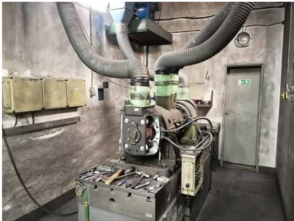
Obr. 38 Stávající zkušební stanoviště pro trakční motory
