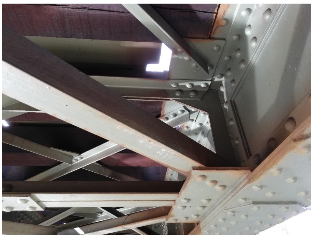
Obrázek 7 – Detail připojení příčniku a brzdných ztužidel
