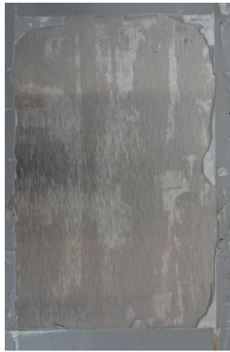
Epoxidový nátěr v solné mlze
