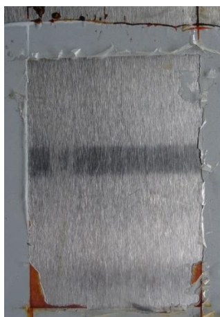
Epoxidový nátěr v SO 2
