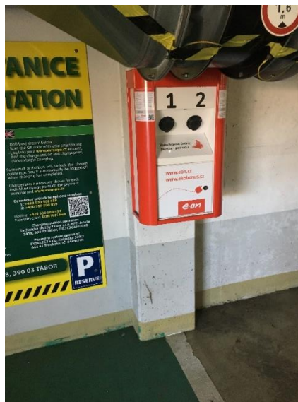
Obrázek 42. Nabíjecí stanice v Parking Centrum
