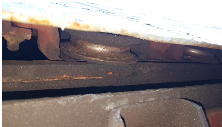
Obr. 8 Závada 6.6.2.2. Vnější kapota vozu Shimmns je mimo vedení, foto: archiv autora
