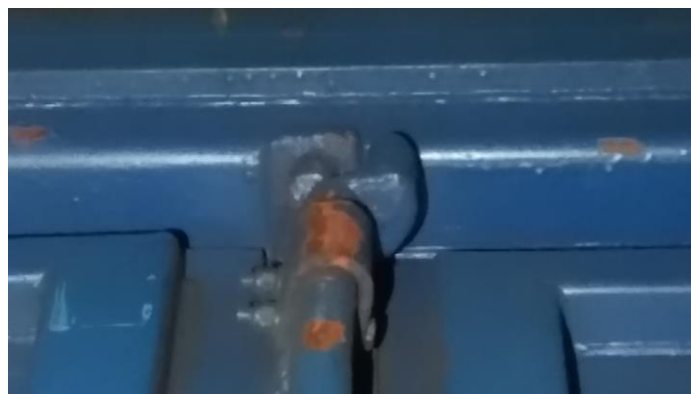
Obr. 10 Závada 6.1.6.1 Dveře nedostatečně zajištěné, foto: archiv autora
