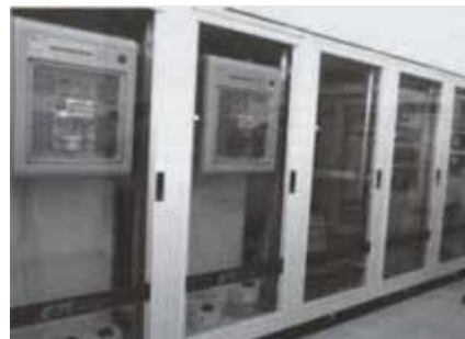
Obr.: Pohled na vybavení monitorovací stanice s řadou průtokových analyzátorů (převzato z literatury, cit. [10])
