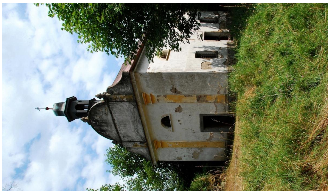
Obr. 1 Kaple Panny Marie před rekonstrukcí, pohled z jihovýchodu (foto Hugo Sedláček, 2010)
