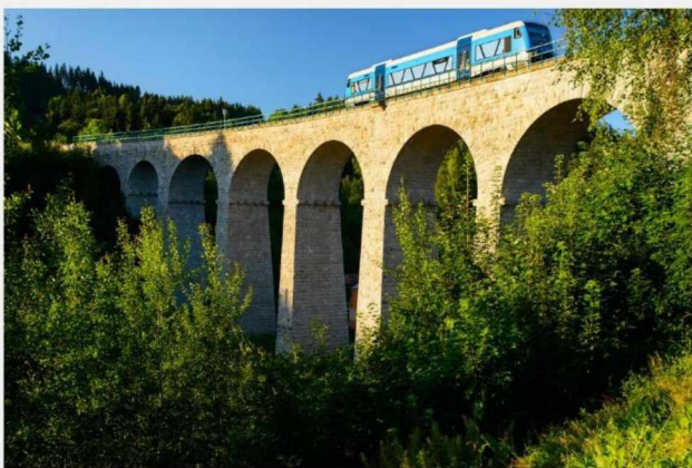
Historický kamenný viadukt je po rekonstrukci opět ukázkou umění železničních stavitelů 19. století.
