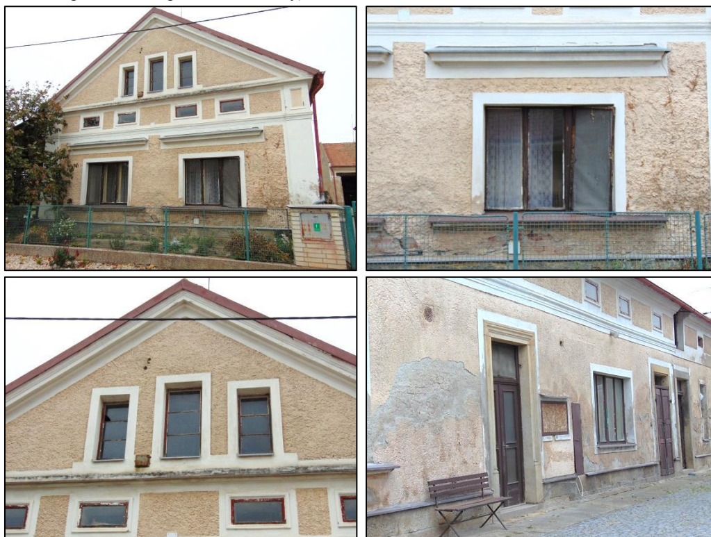
Plotiště nad Labem, ul. U Melounky čp. 12 (Průčelí; Okenní orámování v přízemí; Detail štítu a mezipatra; Detail pravé delší strany)
