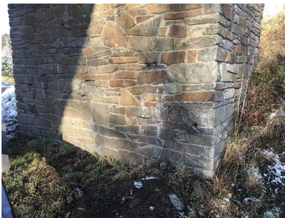
Obrázek 23. - Vypadané spárování pilíř P2
