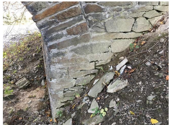
Obrázek 22. - Vypadané spárování opěra P1
