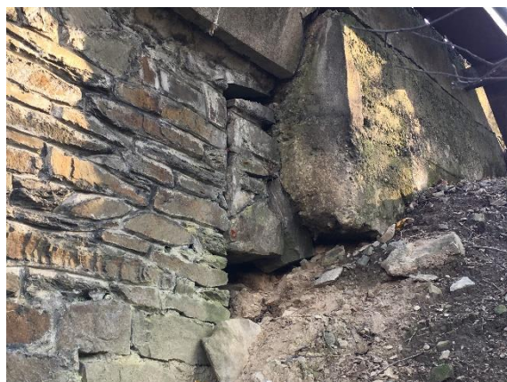
Obrázek 26. - Odpadávající přech. zed'
