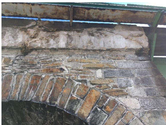
Obrázek 29. - Praskliny na římsě OP2
