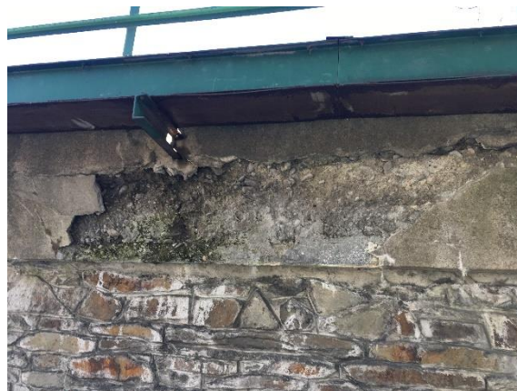
Obrázek 30. - Odpadávající část římsy OP2
