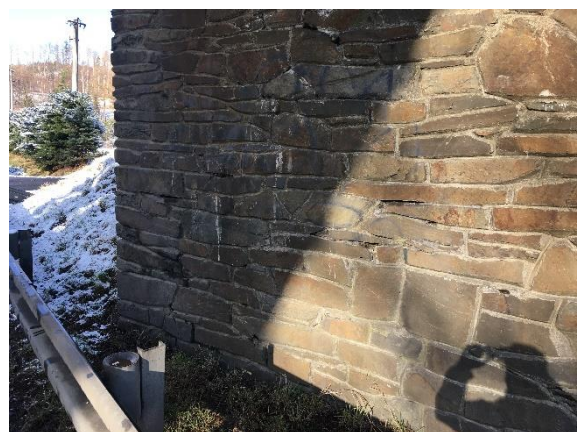
Obrázek 24. - Vypadané spárování pilíř P2
