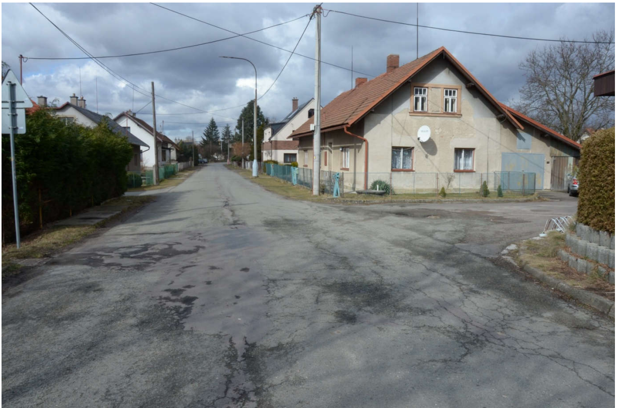
Obrázek 10: km 0,080 Zásobování obchodu vpravo, uliční vpusť a nepoužívaná výstupní plocha BUS vlevo, poruchy krytu
