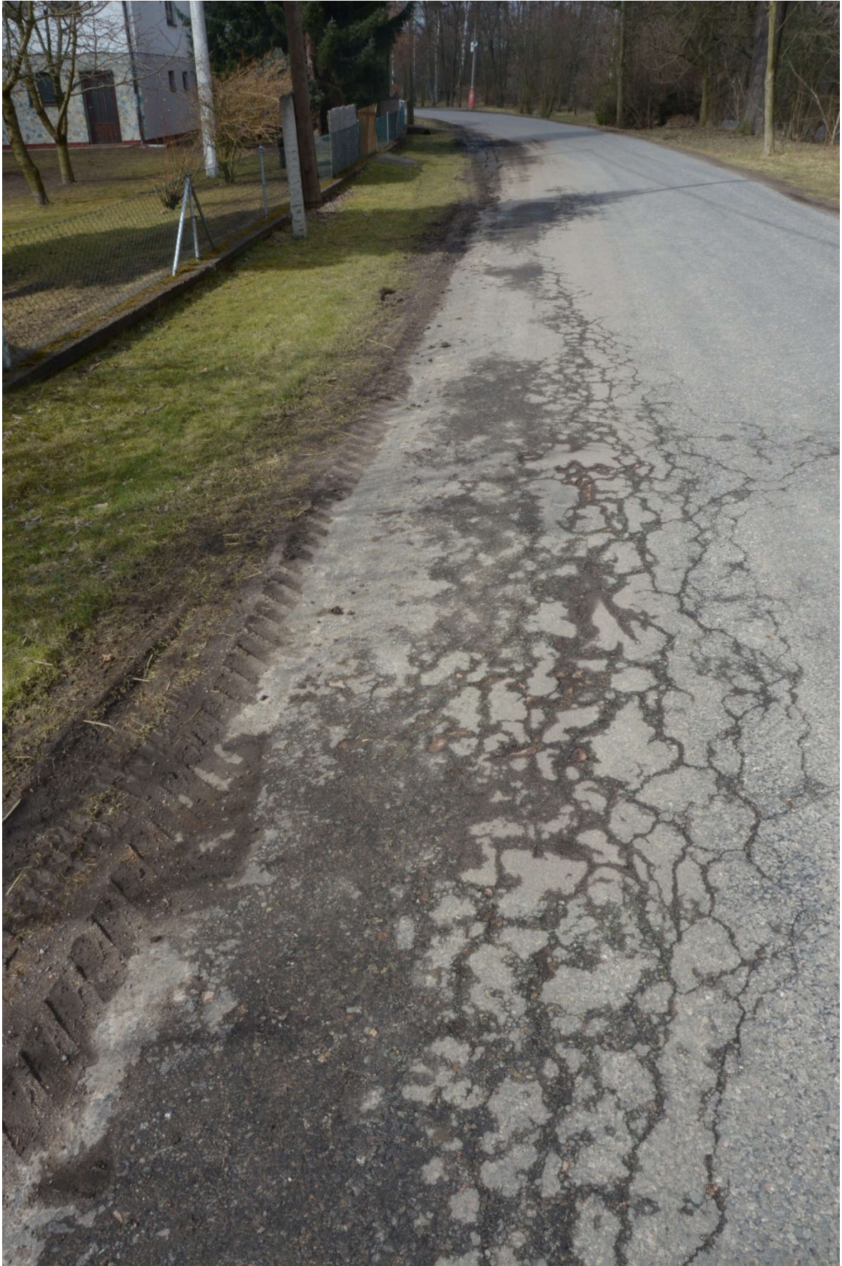
Obrázek 17: km 0,370 Detail poruch krajů vozovky
