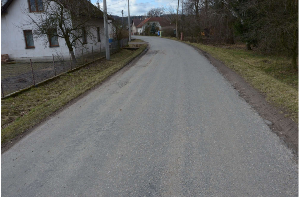
Obrázek 20: km 0,580 Zanesený levostranný příkop zakončený příčným propustkem
