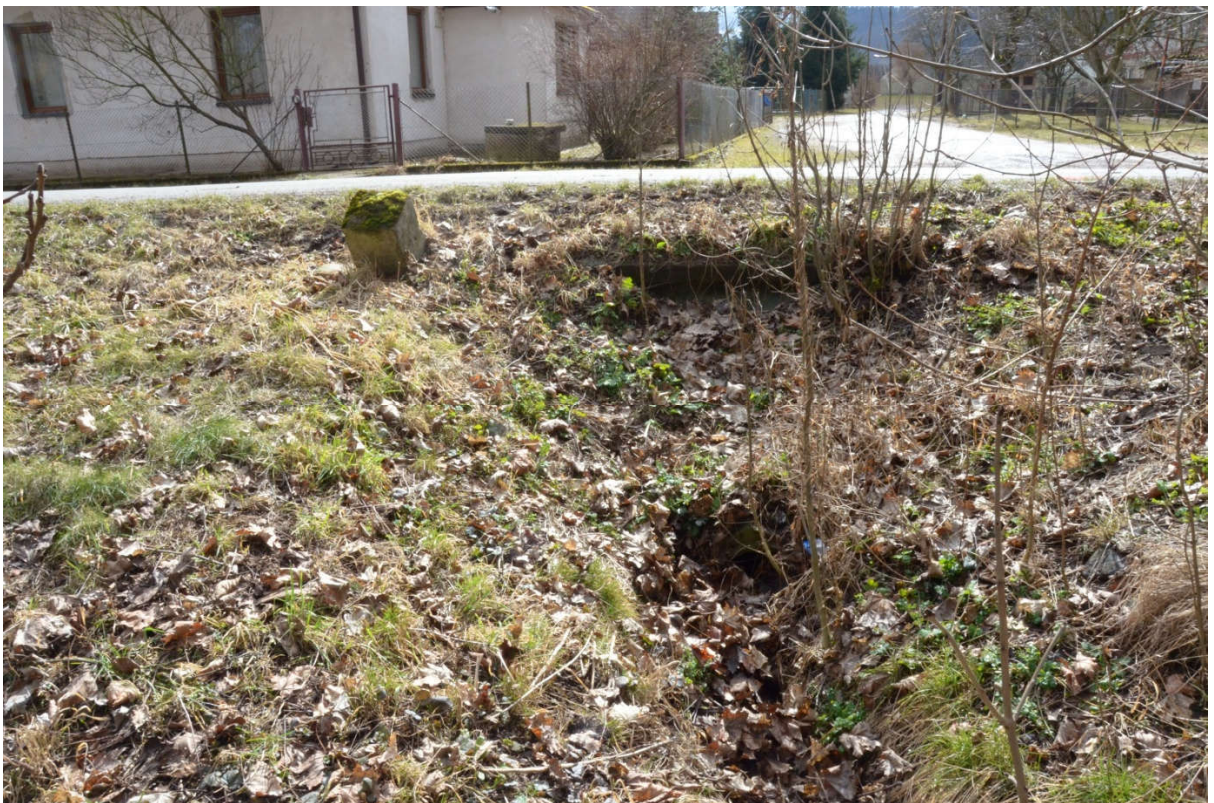
Obrázek 21: km 0,610 Výtok zaneseného propustu
