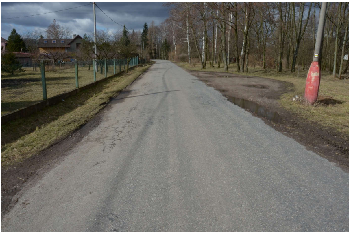
Obrázek 19: km 0,440 Nezpevněná odstavná plocha, zanesený příkop
