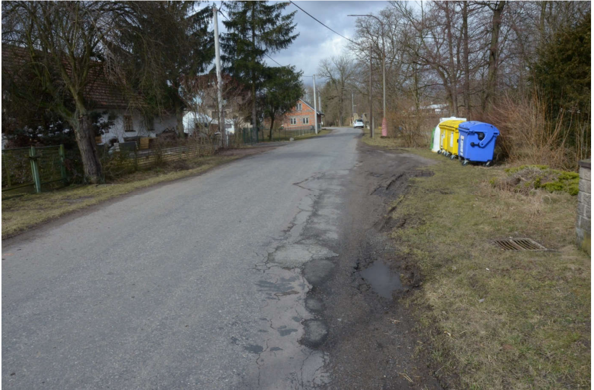
Obrázek 13: km 0,250 Sběrné místo recyklovaného odpadu, poruchy kraje vozovky vlivem špatného odvodnění
