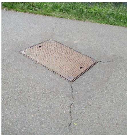
Obr. 8.1. Trhliny v asfaltovém chodníku u rohů kovového krytu, vzniklé účinkem teplotních napětí.
