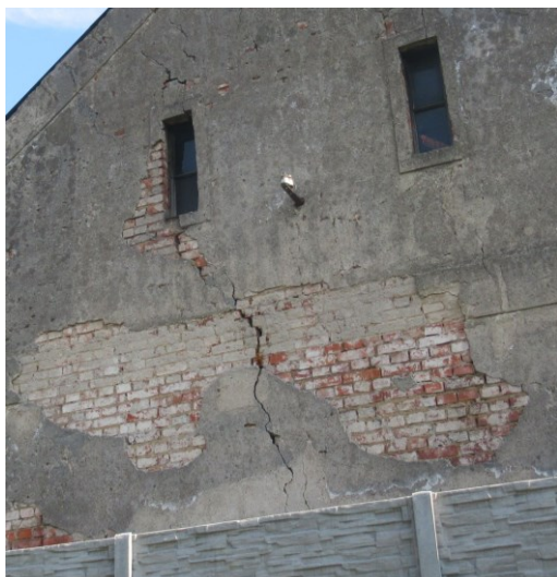
Obr. 9.4. Trhlina ve zdi staré budovy.
