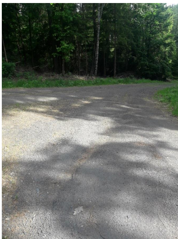
Obrázek 37. Aktuální stav lesní cesty Jabloňová - začínající erozní rýha
