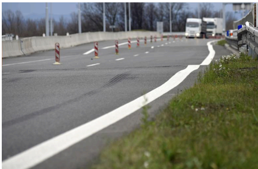
Obr. 44: Zvlnění dálnice D47. [26]
