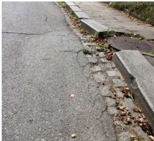
Obr. 39: Hrbol u okraje vozovky vzniklý objemovou změnou podkladních vrstev. [23]
