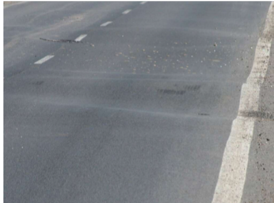
Obr. 40: Podélné hrboly způsobené objemovými změnami. [23]
