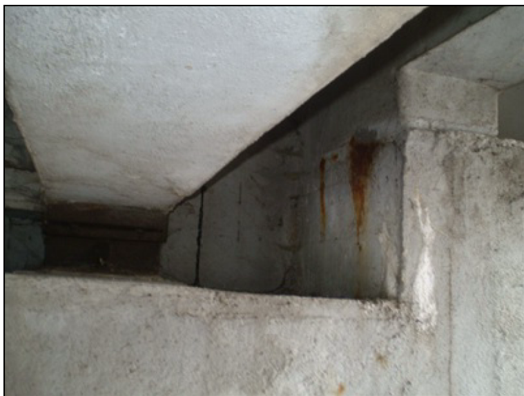
Koroze uložení vlevo na opěře OP1.JPG
