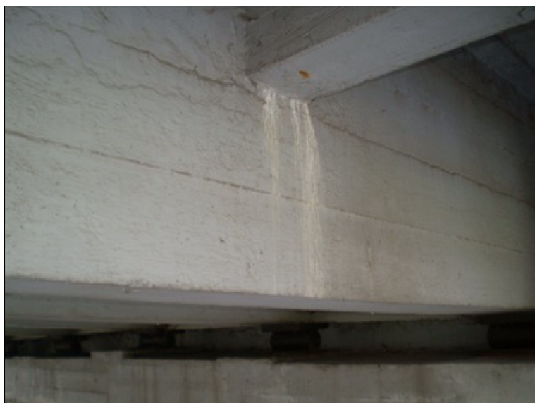
Poškozená izolace vpravo na konci.JPG
