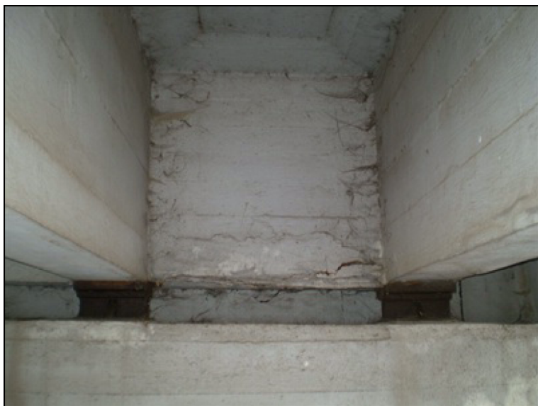
Trhliny v příčniku nad OP1 mezi 3. a 4. trámem.JPG
