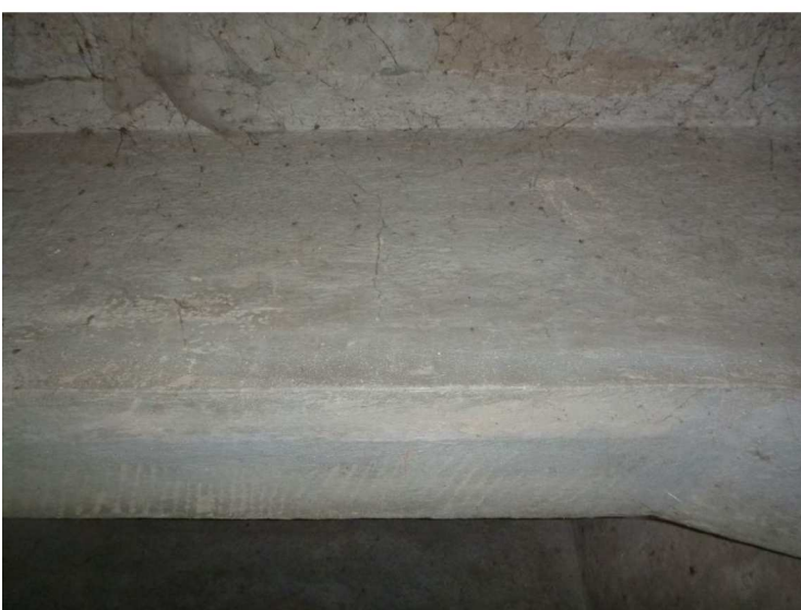
svislé trhliny na trámech NK
