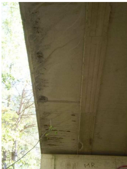
podhled pravého krajního nosníku v 1.poli
