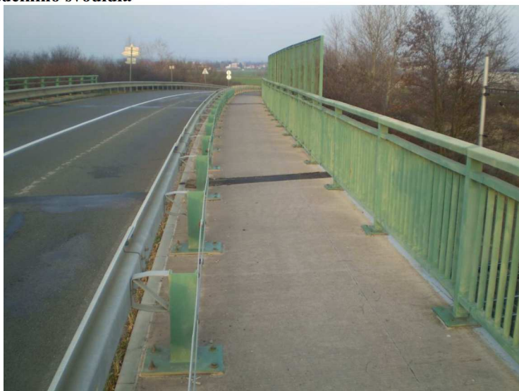
lokální koroze zábradelního svodidla
