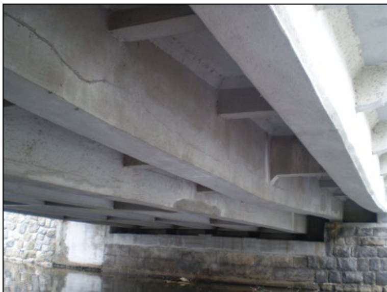
Podélná trhлина 7.trámu zprava.JPG
