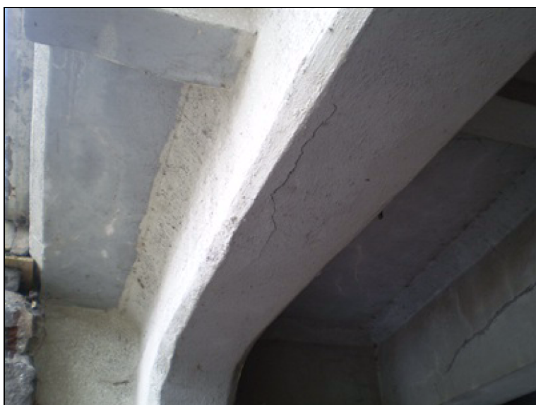
Trhлина na pohledu krajního trámu vpravo u OP1.JPG
