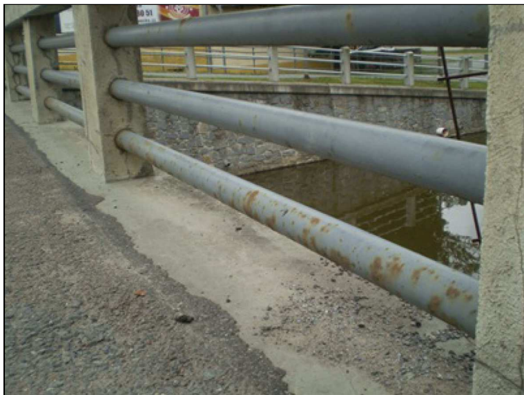
Koroze vodorovné výplně zábradlí.JPG
