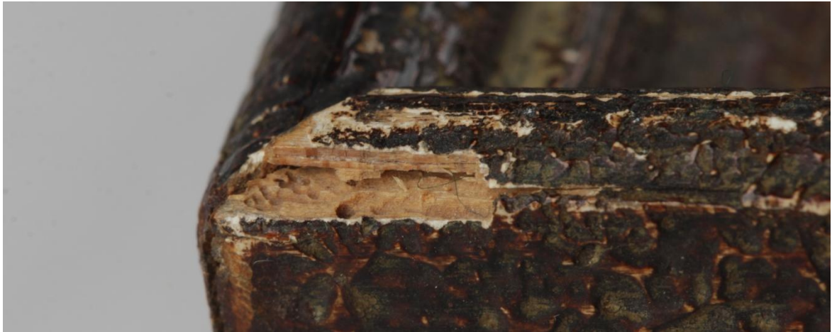
Obr. 17. Detail – pravý horní roh rámu, odření povrchové úpravy, poškození působením dřevokazného hmyzu, pohledová strana, stav před restaurováním, zábleskové světlo.
