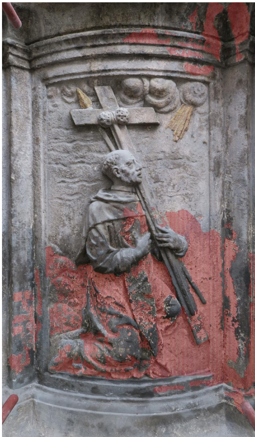
Obrázek 14 – Zákresy poškození – narušený povrch
