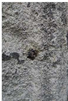
N1 – degradovaný povrch
