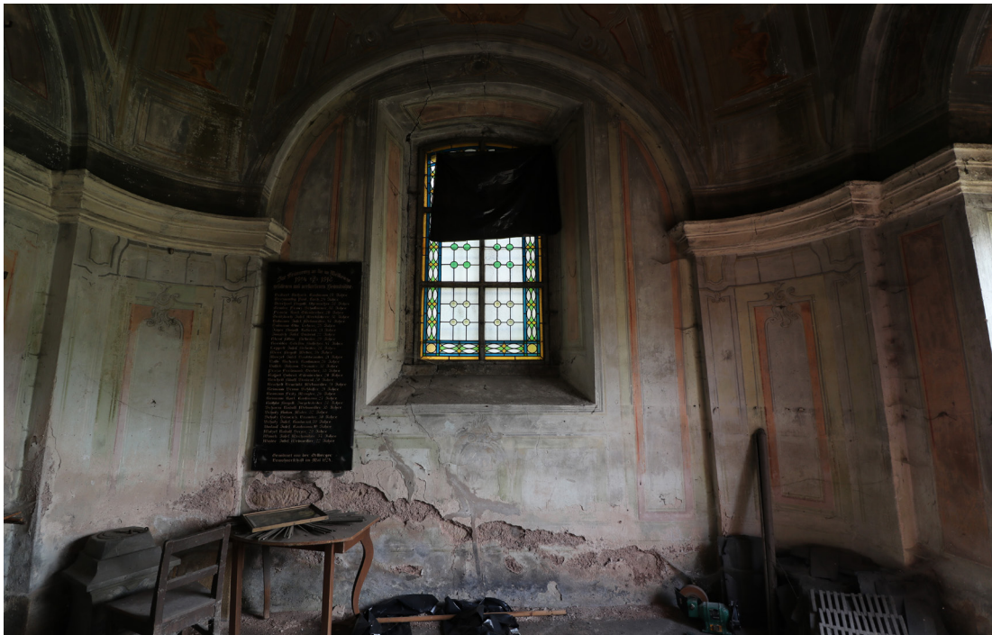
Exterier kaple - přerostlá zeleň, zvýšený terén, nevhodné zaústění okapů, poškození omítek na soklových partiích v interieru (vlhkost, zasolení).
