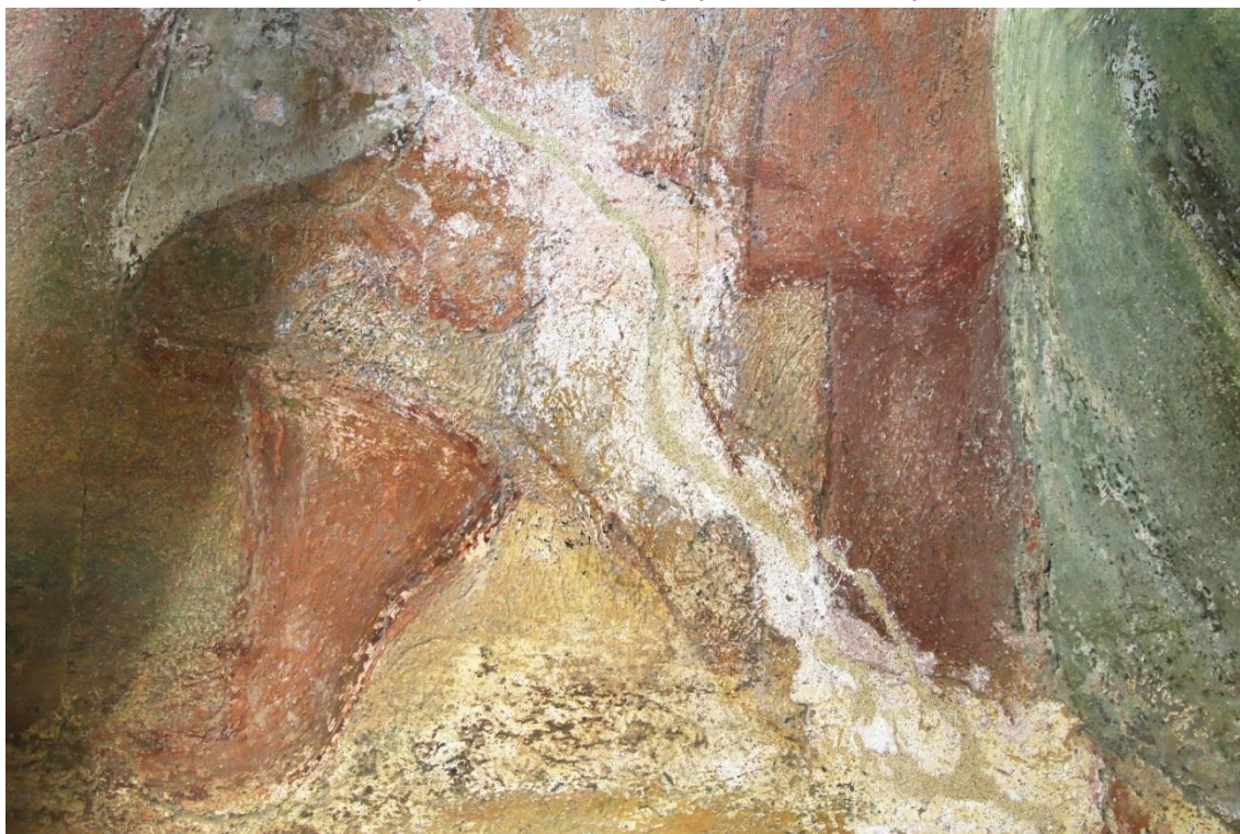
Obr. 45 Oblast statické trhliny při dolním okraji malby v oblasti figur, restaurovaný úsek. Stav po tmelení a injektáži.
