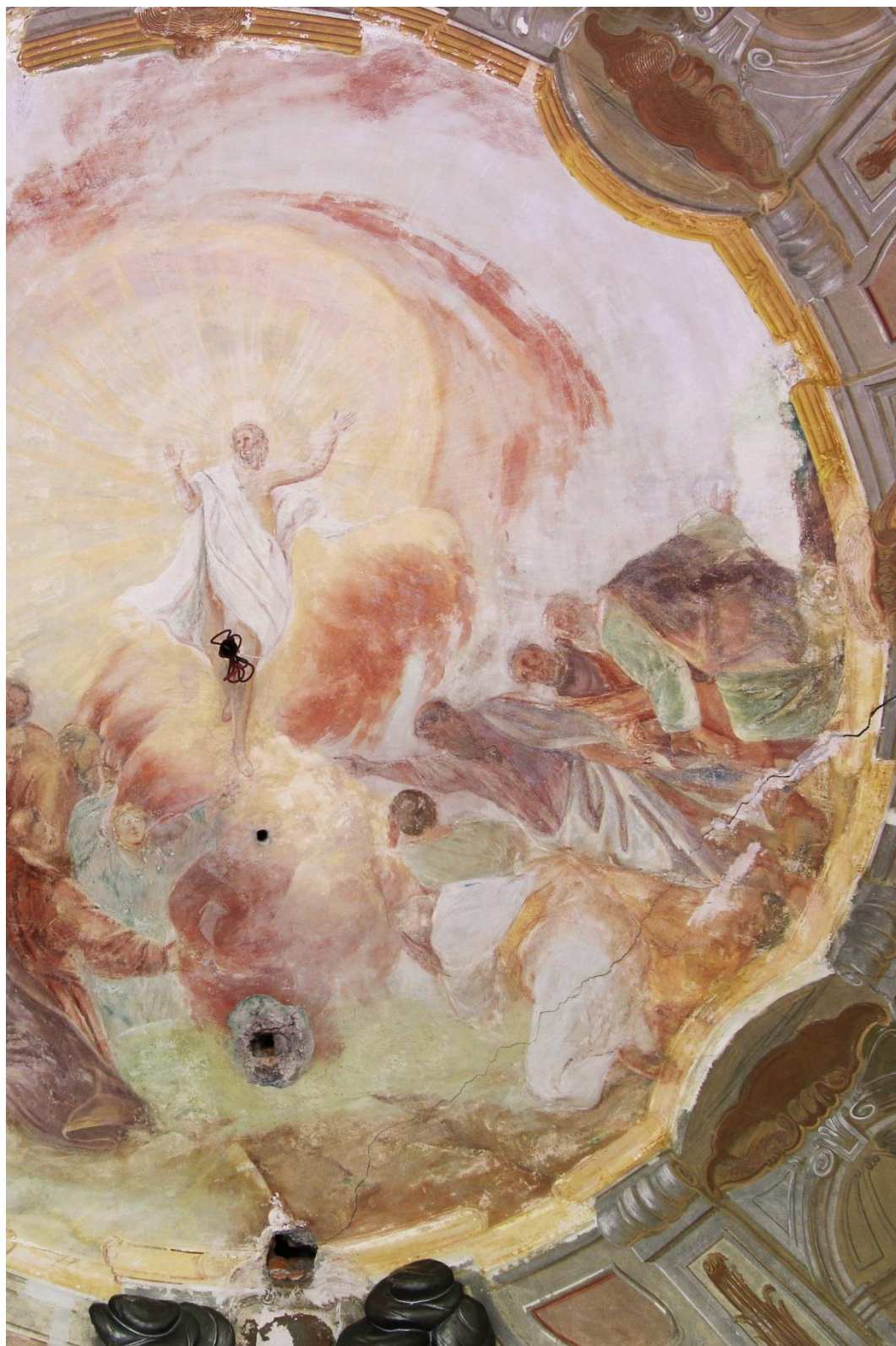
Obr. 43 Pravá polovina nástropní malby Nanebevstoupení Krista. Stav těsně před dokončením odstraňování přemalby z 19. stol
