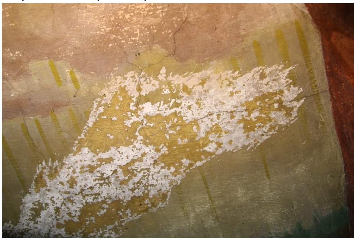
Obr. 26 Poškození přemalby z 19. stol. - odlupování a úplná ztráta barevné vrstvy na povrchu sádrových tmelů. Oblast oblohy nalevo od levé skupiny apoštolů, mimo restaurovaný úsek. Stav před restaurováním.
