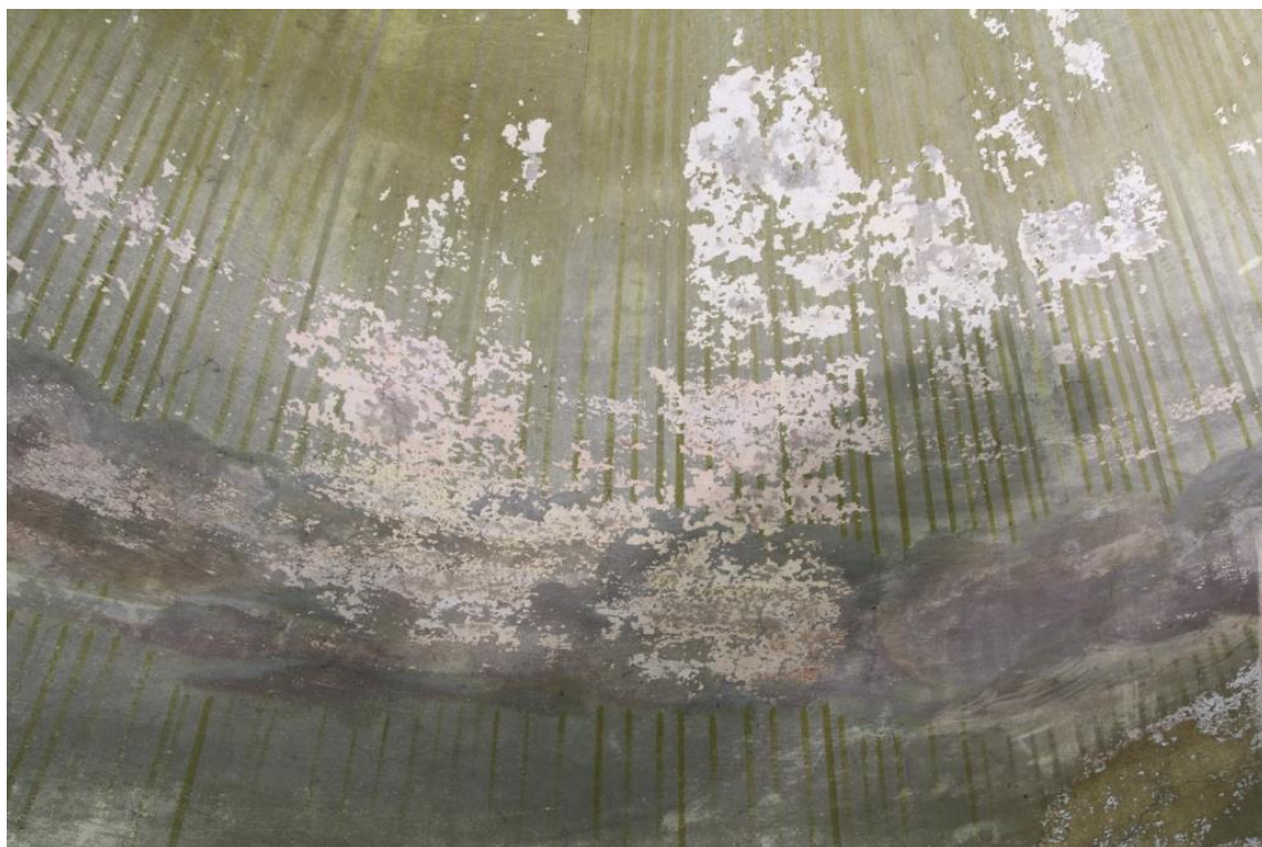
Obr. 25 Poškození přemalby z 19. stol. - odlupování a úplná ztráta barevné vrstvy. Oblast oblohy, mimo restaurovaný úsek. Stav před restaurováním.
