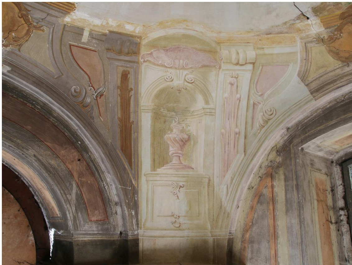
Obr. 8 Část původní barokní nástěnné malby iluzivní architektury zrestaurovaná v rámci jiného restaurátorského zásahu. Pendentiv, západní kout kaple. Stav po restaurování.
