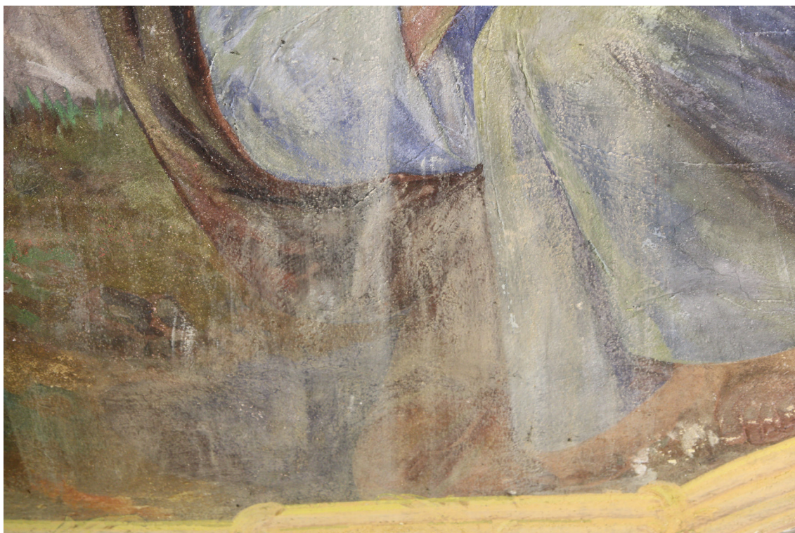
Stav malby na vybraných místech - Nahoře poškození od zatékání. Dole poškození od mechanického čištění na levé skupině od oltáře (provedeno patrně někdy ve 20. století).
