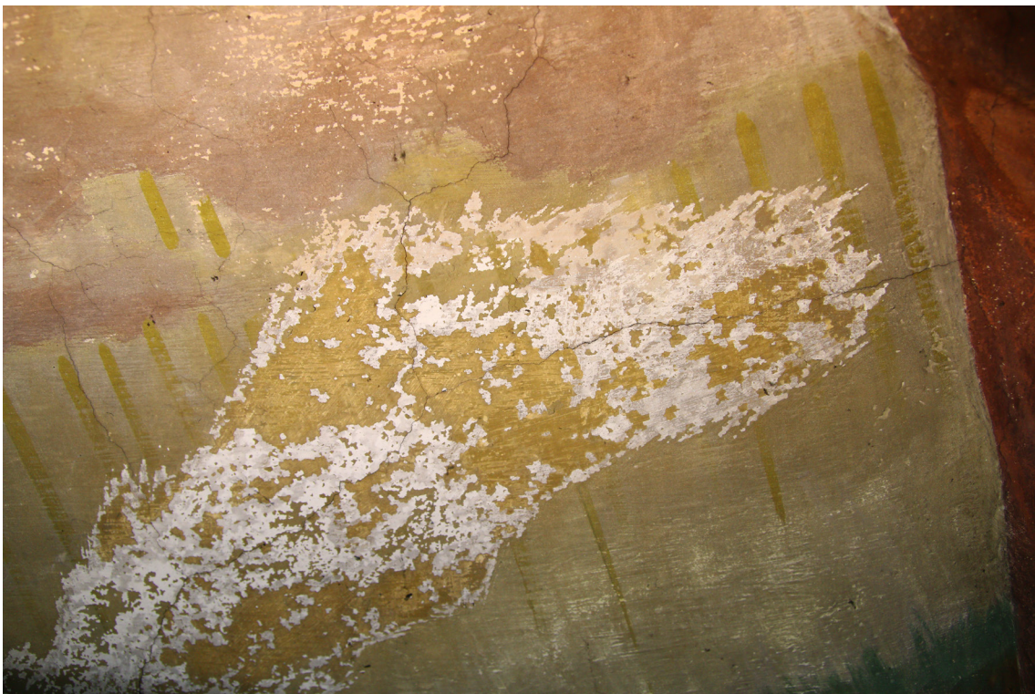
Stav přemalby na vybraných místech - detaily puchýřovitění a zpráškovatění. Nahoře - pod přemalbou prosvítá barokní malba. Dole - vysprávka trhliny se propisuje na povrch.
