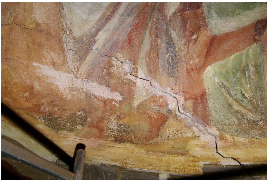
Obr. 30 Ztráta původní barevné vrstvy v místech, kde byla překryta druhotnými tmely. Oblast nohou figury B, restaurovaný úsek. Stav po sejmutí přemalby a druhotných tmelů a po zajištění statických trhlin přeplepy.
