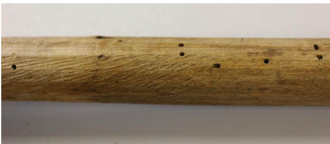
Obrázok 83 Stav drevenej žrde po vytmelení defektov voskoživičným tmelom
