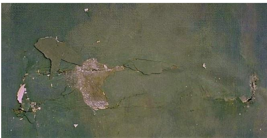
Obrázok 111 Detail poškodenia maľby - delaminácia
