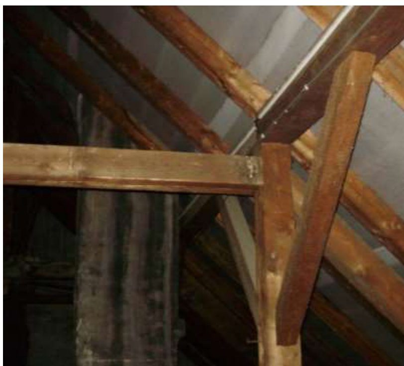
Fotografie č. 27: Krov nad hlavní budovou, pohled na plnou vazbu (Zdroj: Vlastní fotografie)
