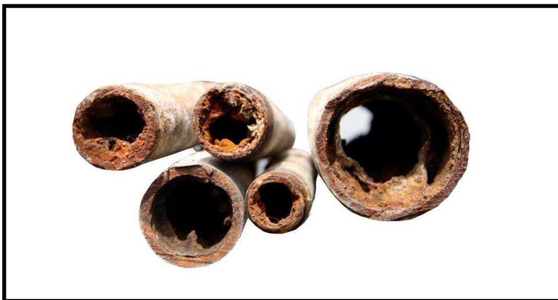
Obr. 13: Usazené železo a mangan v potrubí
