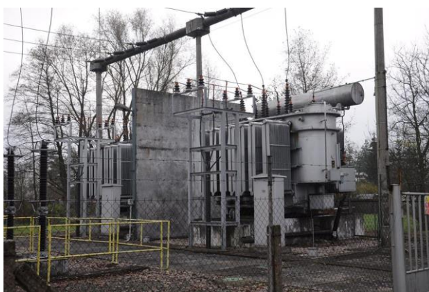
obr 3 - Transformátor 110 kV/22 kV [4]
