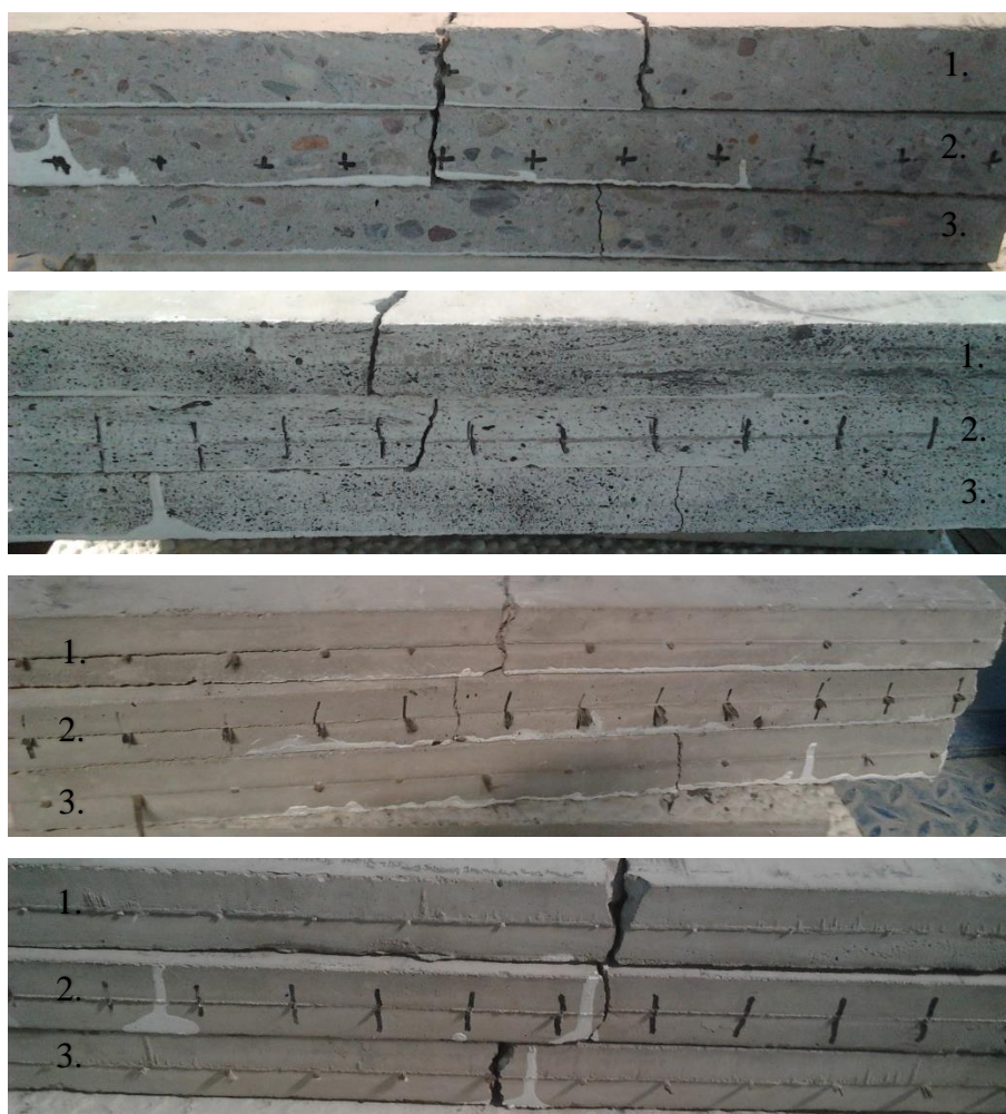
Obrázek 53. – Detail ukládání sítě a trhlin v deskách Alligard
