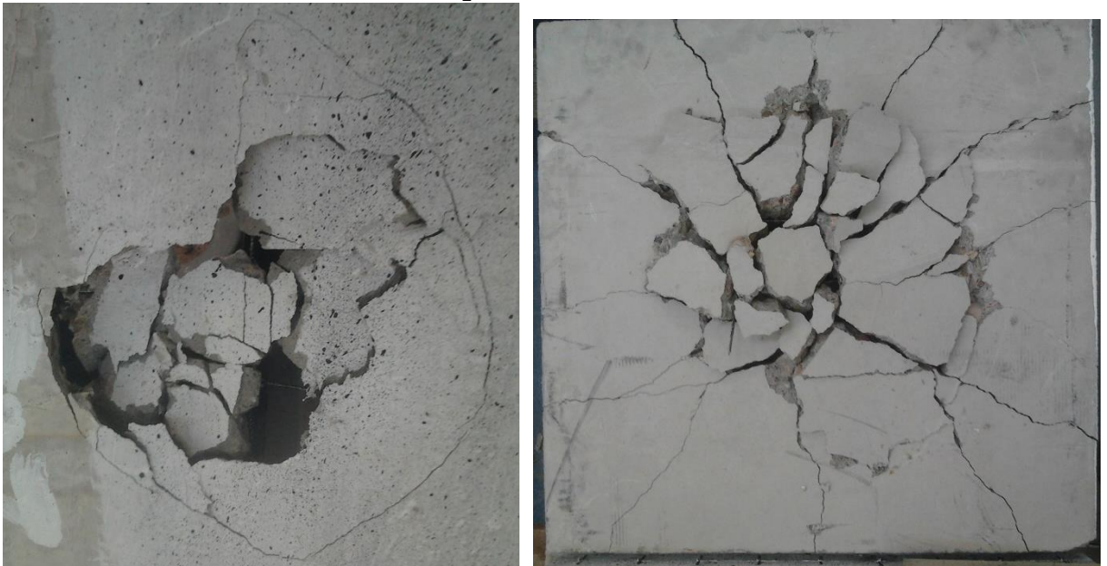
Obrázek 55. – Detail kruhové praskliny na horním povrchu, porušené zkušební těleso 2.1.1.
