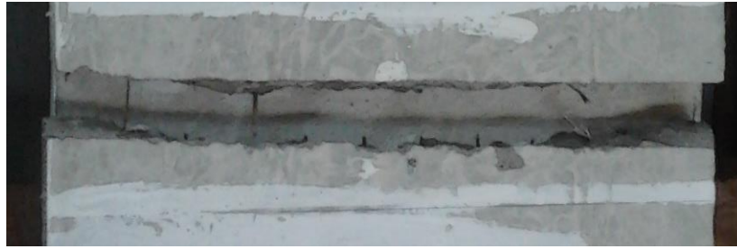
Obrázek 43. b) – Detail porušené zkušební těleso 1.1.
