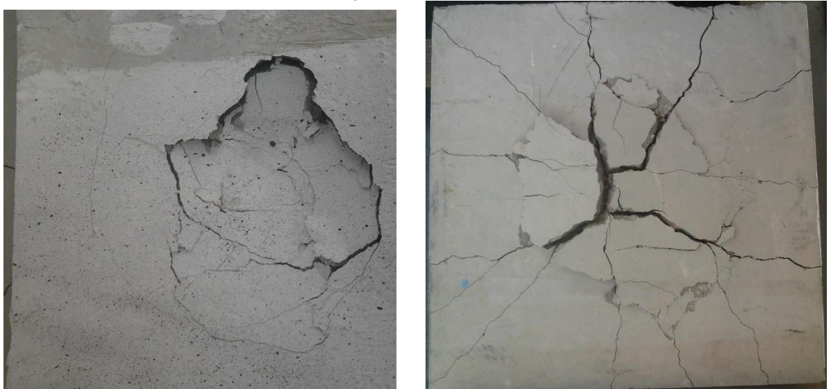
Obrázek 56. – Detail kruhové praskliny na horním povrchu, porušené zkušební těleso 2.3.2.
