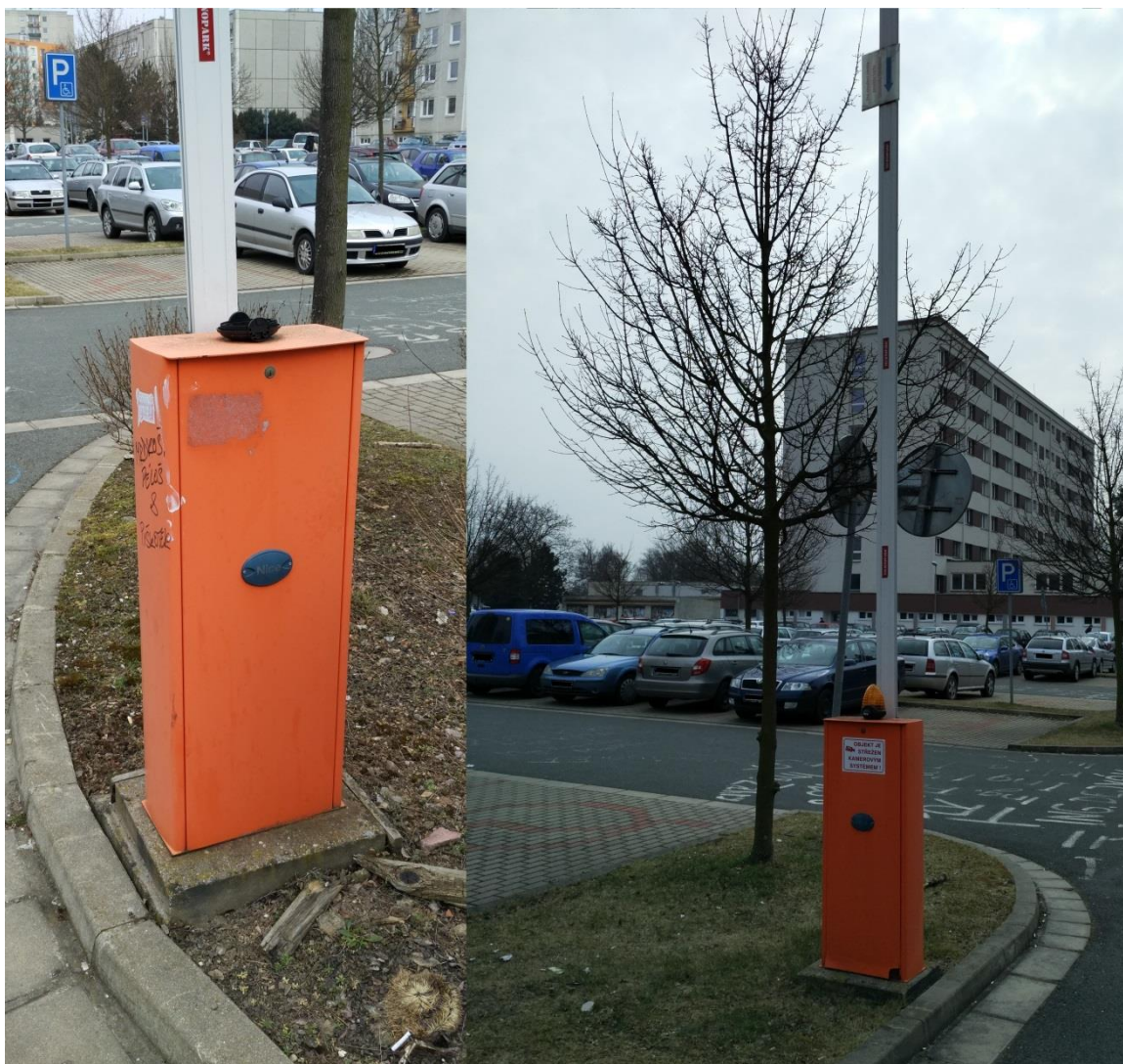
Obr. 3. Přístupové závory mimo provoz
