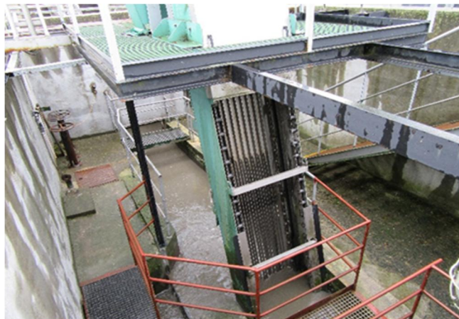
Obr. 2: Hrubé česle – 1. fáze čištění odpadních vod
