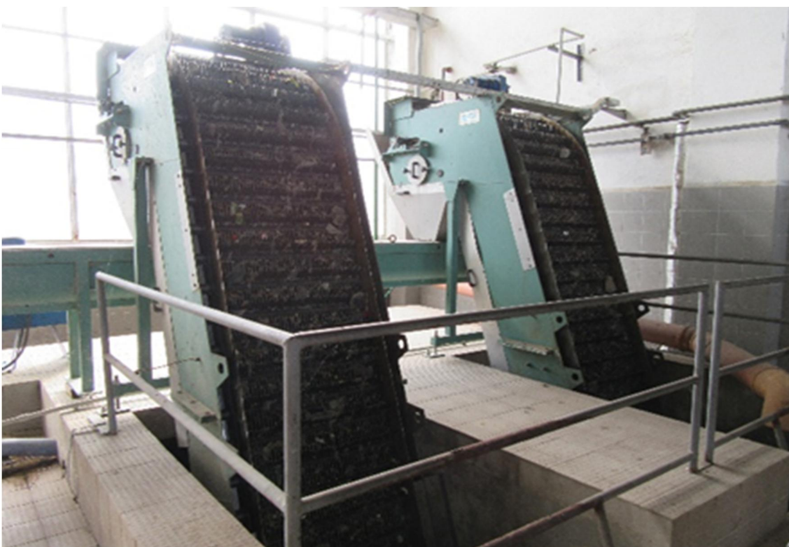
Obr. 3: Jemné česle – 2. fáze čištění odpadních vod
