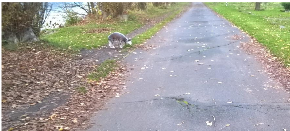
Obrázek 6 Pohled na povrch cyklostezky, který je porušen prorůstajícími kořeny
