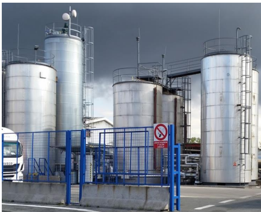
Obrázek 1 Nádrže pro skladování asfaltu a asfaltových emulzí (závod Emulze Kolín, 2017)
