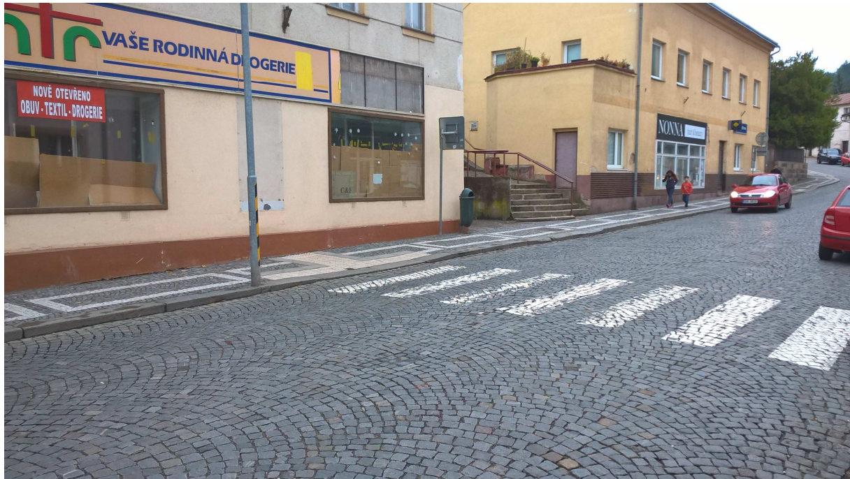
Obr. 7 – Pohled (proti směru staničení) na stávající přechod pro chodce v ul. Pod Městem, který bude zrušen a nahrazen novým přechodem, který bude v místech projíždějícího automobilu.
