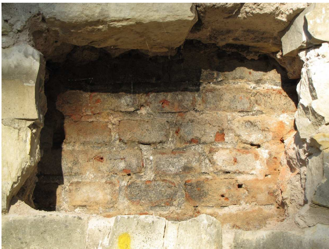
Obrázek 27 Cihlový líc zjištěný v dolním otvoru pro šmorce k budoucímu opěrnému pilíři.
