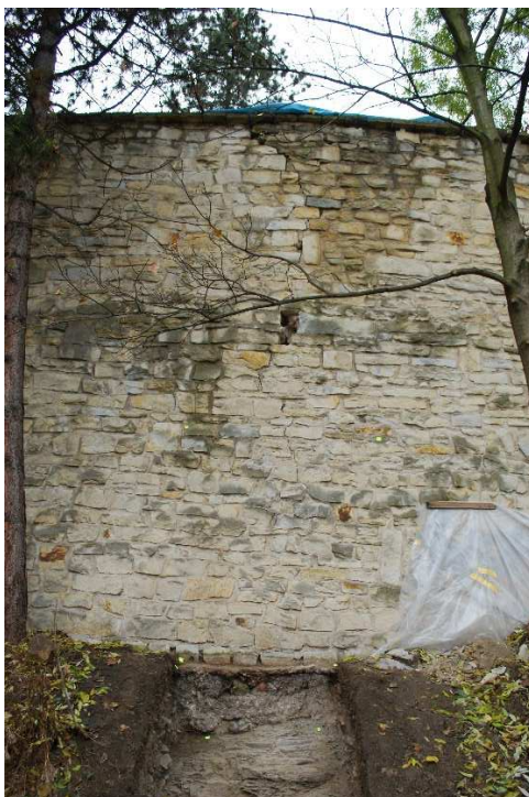
Obrázek 13 Pohled na líc parkánové zdi (podoba zdi před existencí opěrného pilíře). Stav v roce 2009.
