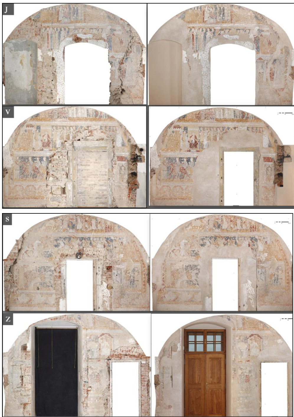
Obrázky 11 a 12 – srovnání stavu nástěnné malby po odkrytí druhotných vrstev (snímky vlevo) a stavu po restaurování (snímky vpravo). Fotogrammetrické zaměření jižní, severní, západní a východní stěny (ortofotoplány).
