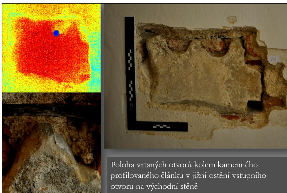
Obrázek 52 – kamenný článek v jižním ostění východní vstupní špalety neinvazivně indikovaný termovizním průzkumem. Styková plocha profilovaného portálu se stezkou a povrchovými úpravami.
