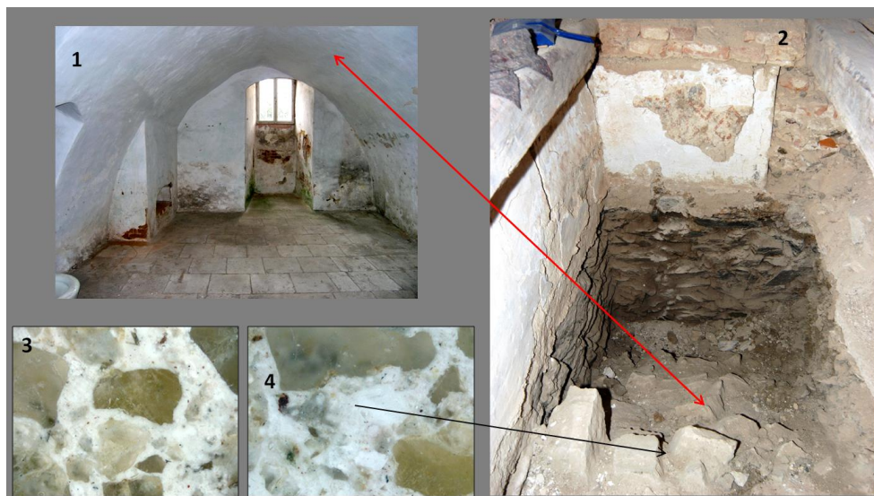
Obrázek 85 – dokumentace zdicí malty druhotně vložené klenby. Pohled jižním směrem (1) do kuchyňské komory (místnost 106) s vyznačením pozice sondy ve vyšším podlaží (2), na snímku odhalený rub klenby a lokalizace odběru zdicí malty. Vlevo mikrosnímky struktury malty (vzorek II/2) na bázi čistého vápna (3,4).
