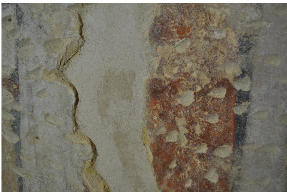
Obrázek 10 – ukázka tmelených ploch pod úroveň původních omítek, jižní stěna.
