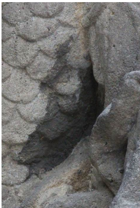
Obrázek 9 Detail - sulfatizovaná povrchová úprava – před čištěním
