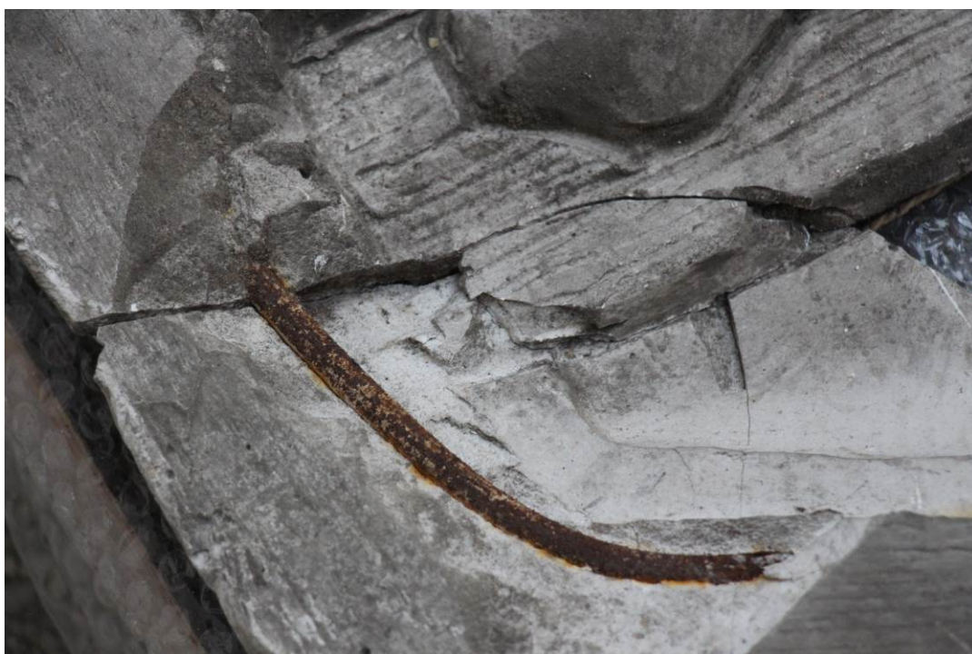
Obrázek 60 Detail – degradace armatury - srovnání
