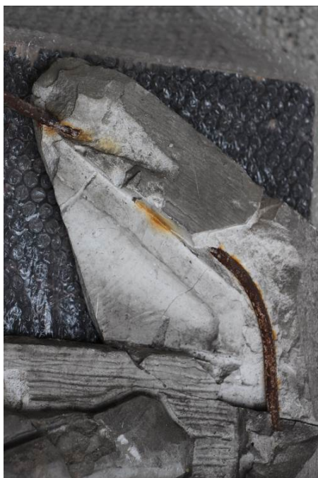
Obrázek 82 Detail - korodovaná armatura
