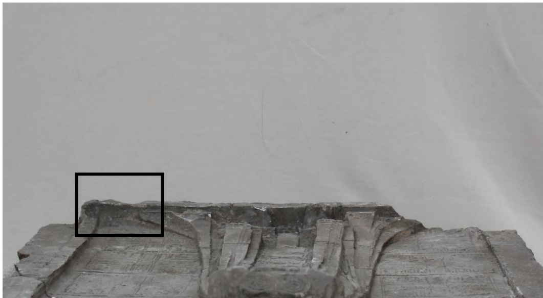
Obrázek 106 Lokalizace místa zkoušky čištění – degradovaný povrch - před
