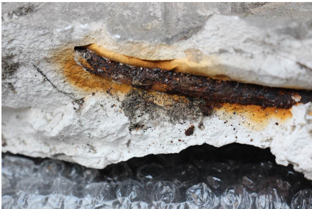
Obrázek 61 Detail – degradace kovové armatury – dutina je dokladem přístupu vzduchu, který způsobil oxidaci
