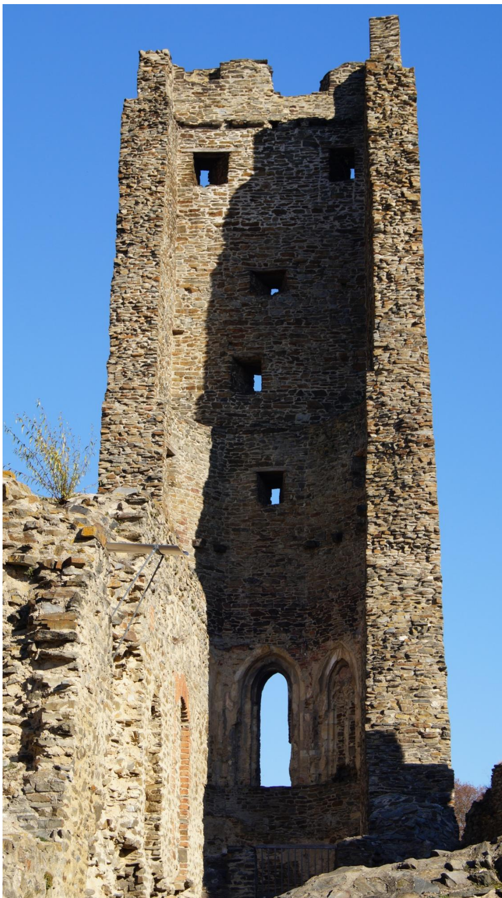
Obr. č. 62: Stav torza věže zříceniny hradu Okoře v roce 2015.
