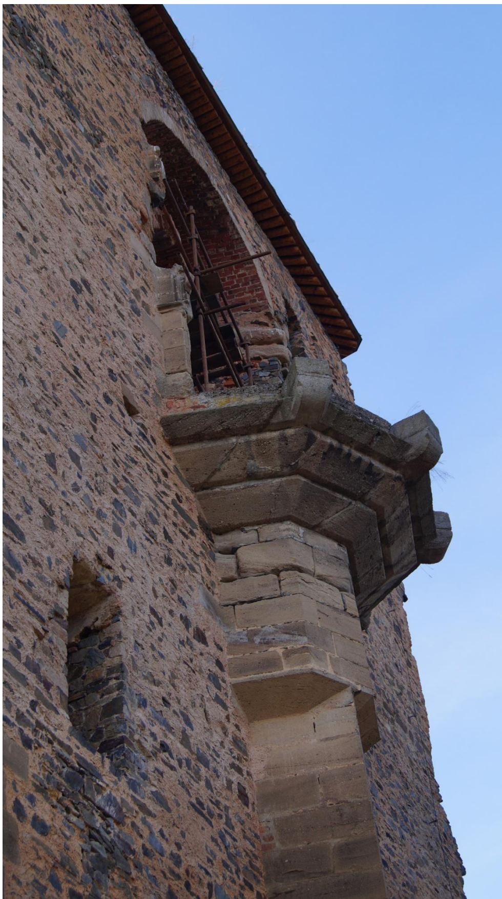
Obr. č. 42: Stav arkýře kaple zříceniny hradu Krakovce v roce 2017.
