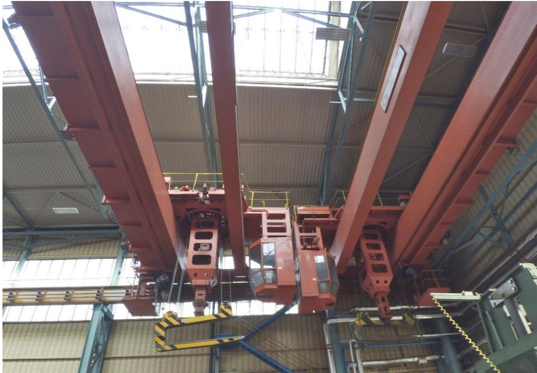
Obrázek 9: Mostový jeřáb v materiálové hale
