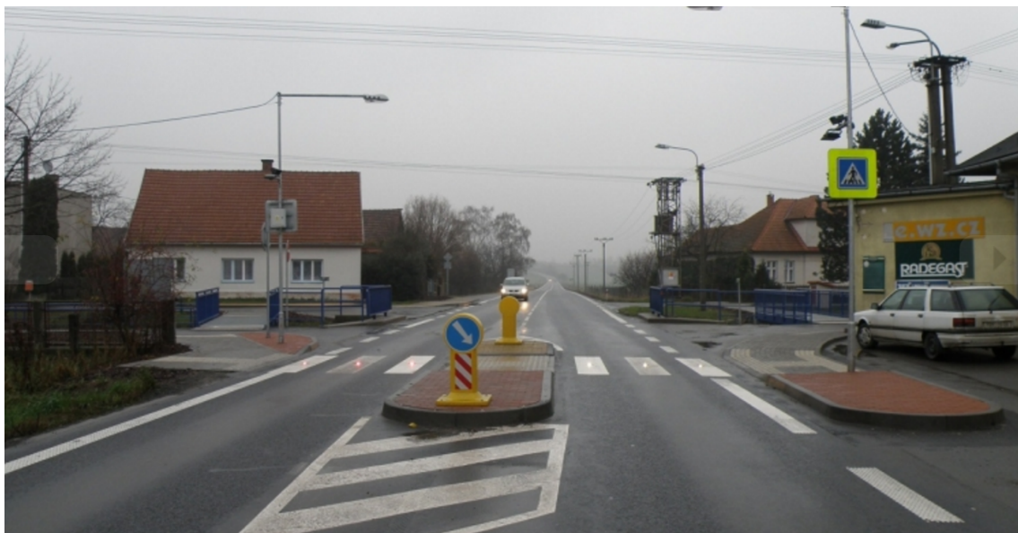
Obr.: Instalace LED návěstidel 3. generace systému bezpečných přechodů společnosti PDSystems s.r.o.
