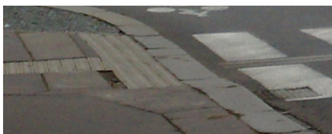
Obr. 12: Detail nerovnosti povrchu navazujícího na varovný pás
