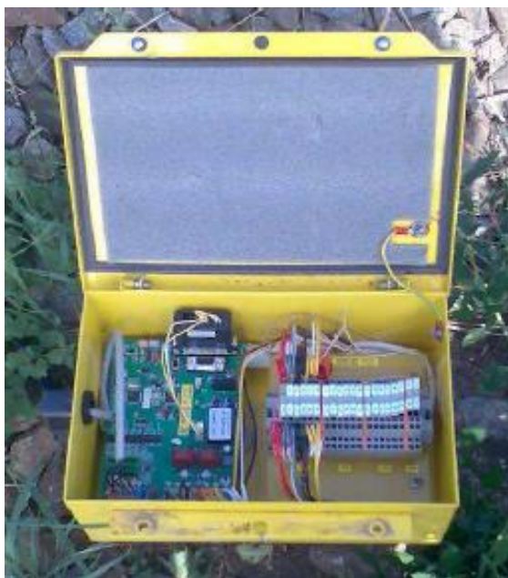
Obrázek 2-13 Detail kabelového závěru PZN-1 [12]
