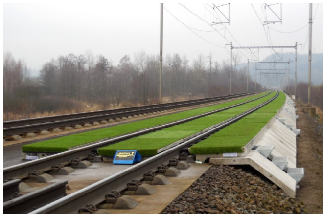
Obr. 32: Absorpční panely přímo v prostoru kolejiště (zdroj: stered.sk).
