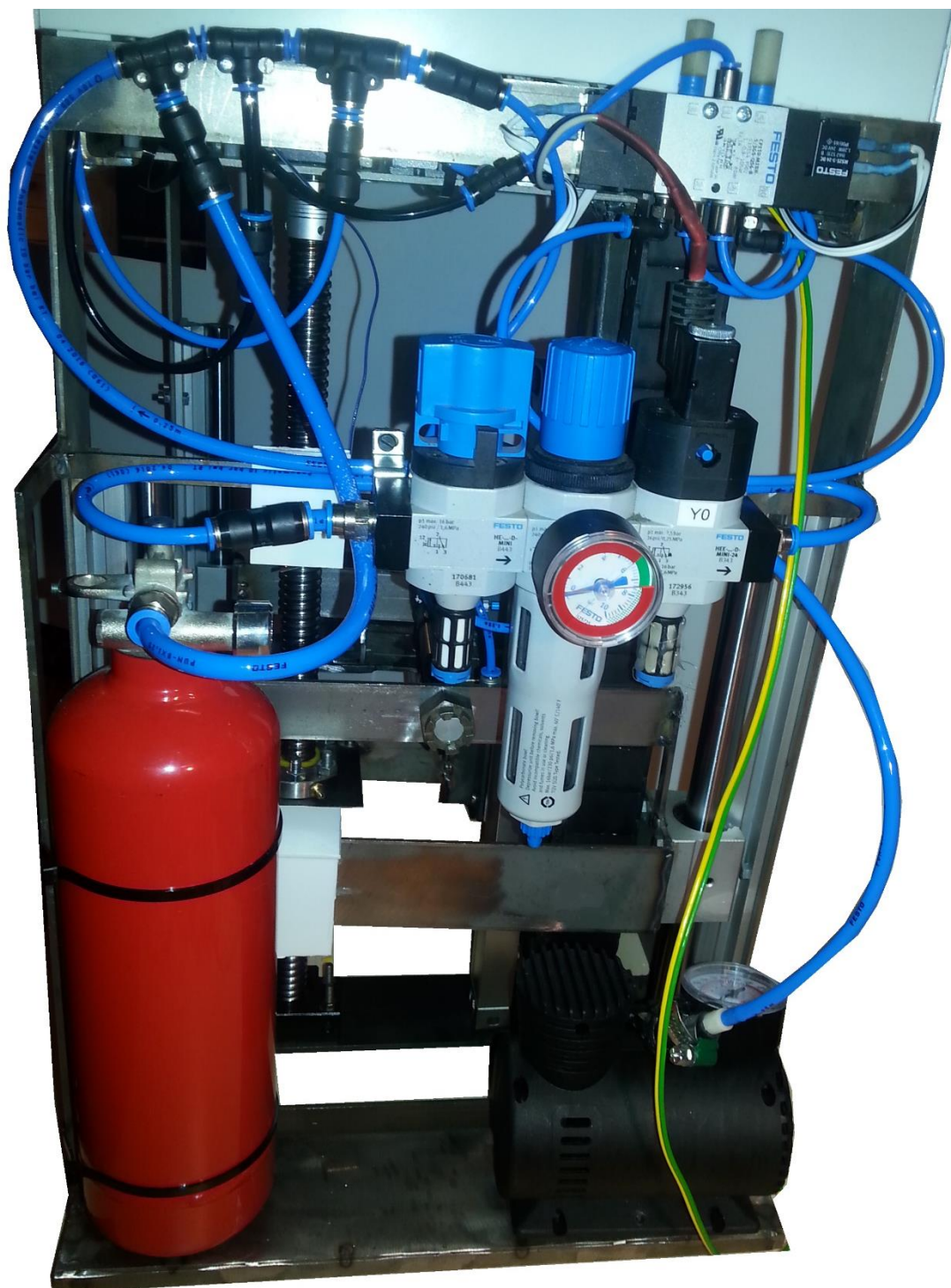
Obr. B3.2 – Realizované zařízení, vzduchotechnika
