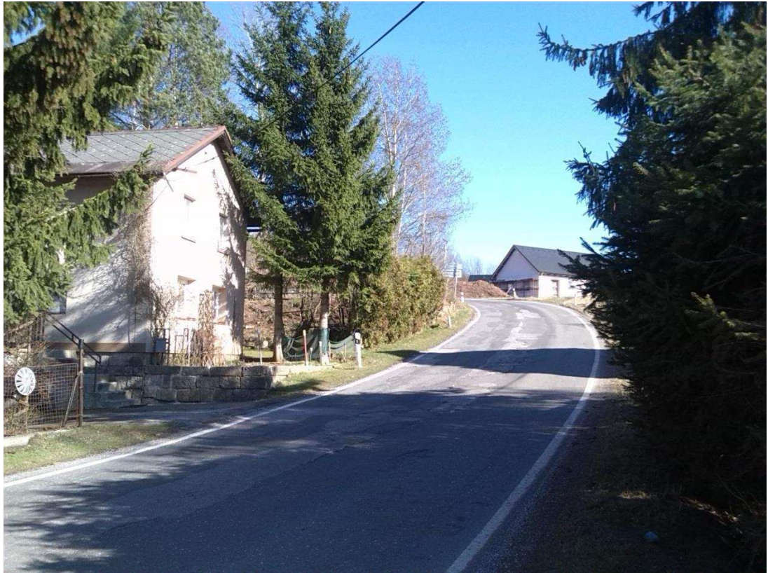
Obr. č.11 – Zeleň překážející ve výhledu; poškozený kryt vozovky
