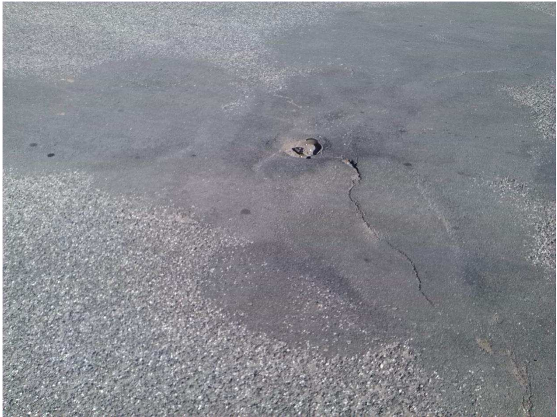
Obr. č.17 – Poškození krytu vozovky
