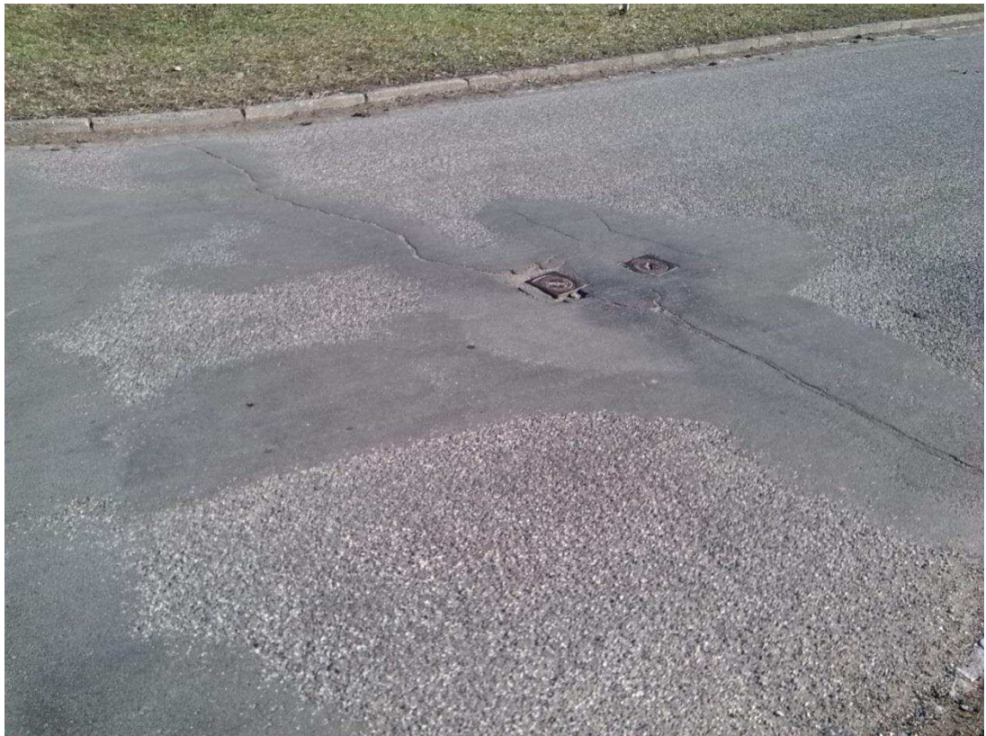
Obr. č.18 – Poškození krytu vozovky
