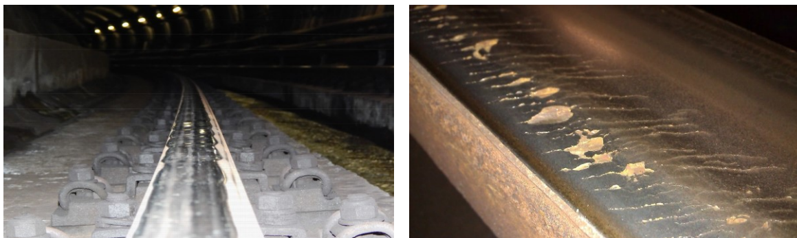
Obr. 2 Vnitřní kolejnice – viditelná vlnkovitost (vlevo), detail vydrolenin (vpravo)
