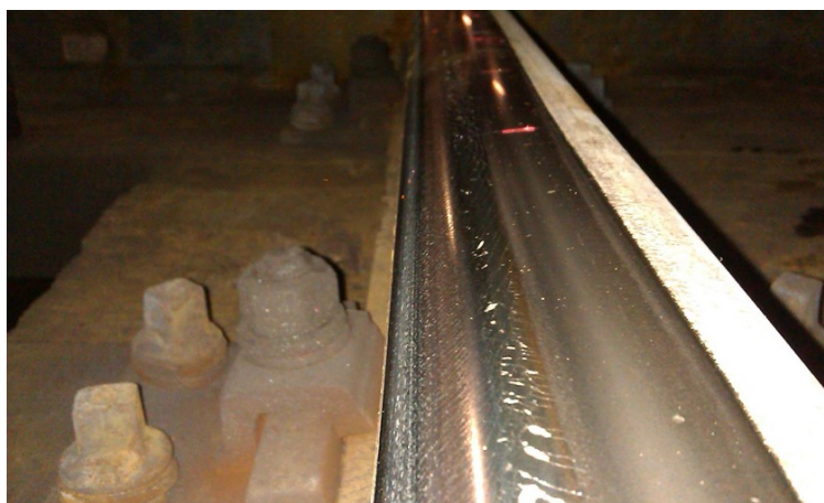
Obr. 13 Boční vyjetí vnějšího kolejnicového pásu, spolu s Head Checkingem
