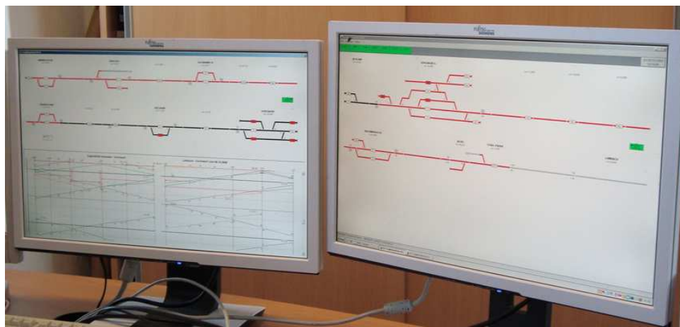
Obrázek M.3 Pracoviště dispečera provozovatele dráhy Stern & Hafferl Verkehrsgesellschaft mbH ve stanici Vorchdorf-Eggenberg, jedná se o zařízení typu StH (StH I), vlevo monitor s tratí Gmunden – Vorchdorf-Eggenberg a splněný grafikon pro obě tratě, vpravo monitor s tratí Stadl Paura – Vorchdorf-Eggenberg
