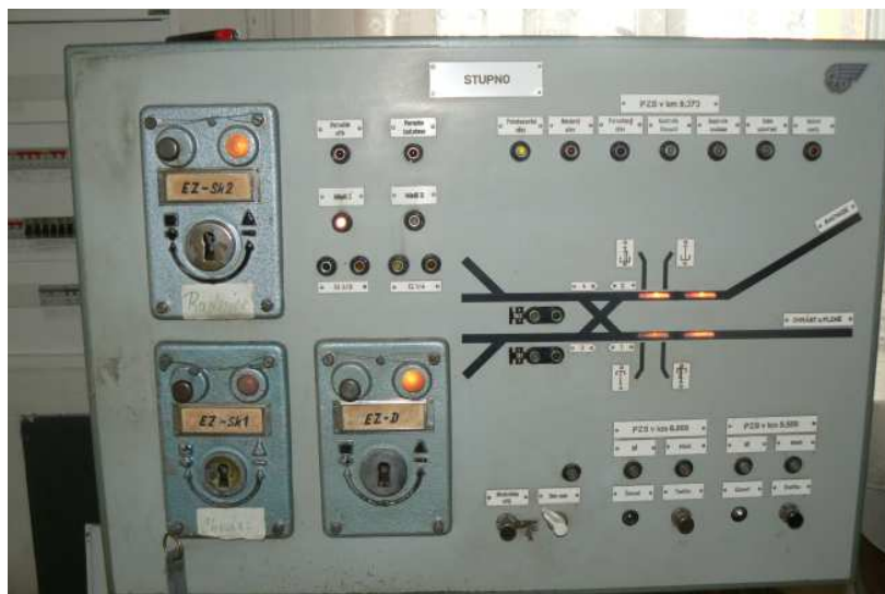
Obrázek 17 Indikační deska s elektromagnetickými zámky EZ-Sk1, EZ-Sk2, EZ-D a kontrolními, ovládacími prvky PZS v km 19,373 (0,242) ve služební místnosti dopravní D3 Stupno
