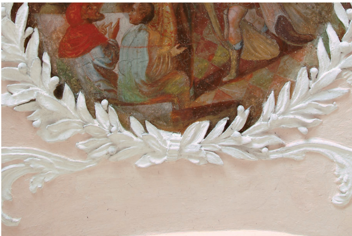
Obr. 72: Detail na časť steny pod výjavom, kde bol pri sondážnom prieskume objavený nápis. Stav pred reštaurovaním.
