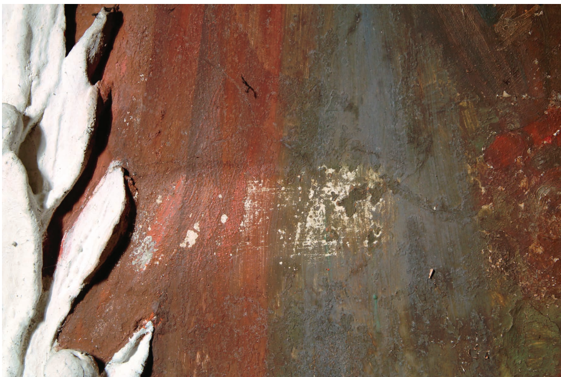
Obr. 32: Detail maľby v klenbe kaplnky (svätováclavský cyklus). Skúška čistenia v oblasti červeného závesu, pomocou isopropanolu a čistiaceho štetca.
