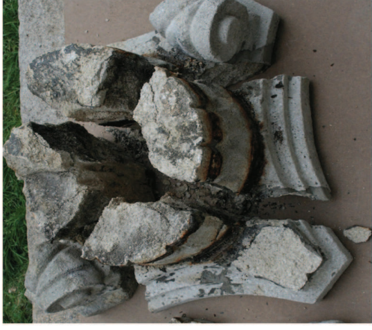
roztržení hlavičky korodujícím čepem, které způsobilo pád sousoší, sloup se sv. Trojicí, Dešná 2010
