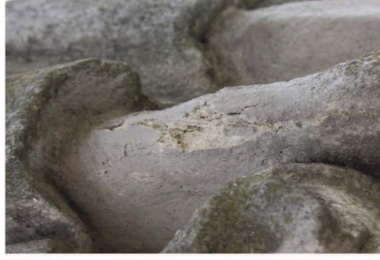
poškození způsobená celoplošným přetmelením povrchu, sv. Jan Nepomucký, Budiškovice 2015
