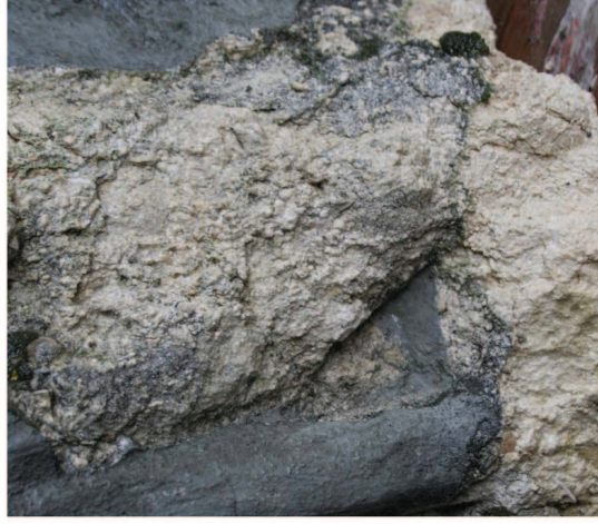
degradovaný kámen pod celoplošným tmelem z šedého cementu, sv. Florian, Cizkrajov 2013
