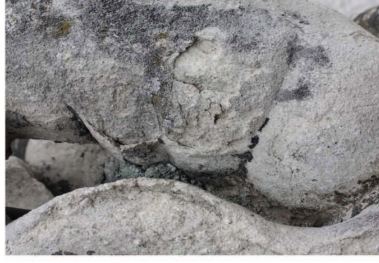
poškození způsobená přezpevněním povrchu, noha a ocas d'ábla na soše sv. Prokopa, Telč 2015
