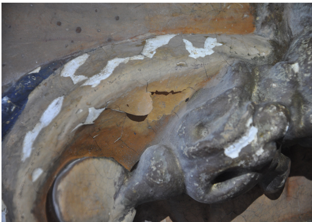
Obrázek 23 - Fotografie krakelů před zažehlením.
