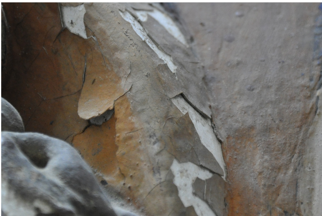
Obrázek 14 - Detailní fotografie síly nánosu barevného souvrství, poškození ztáta adheze barevného souvrství, zprohýbané krakely barevného souvrství – makrosnímek.
