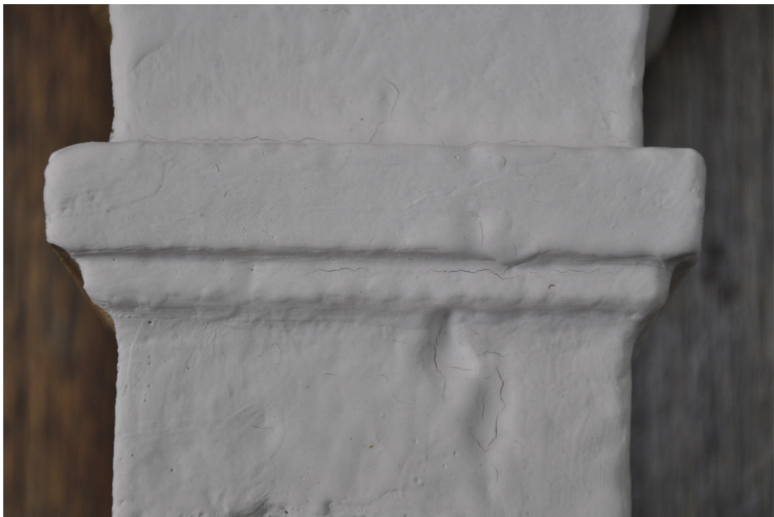
Obrázek 74 - Popraskaná křídová vrstva, poškození způsobené špatnou koncentrací křidové záměsové vody.
